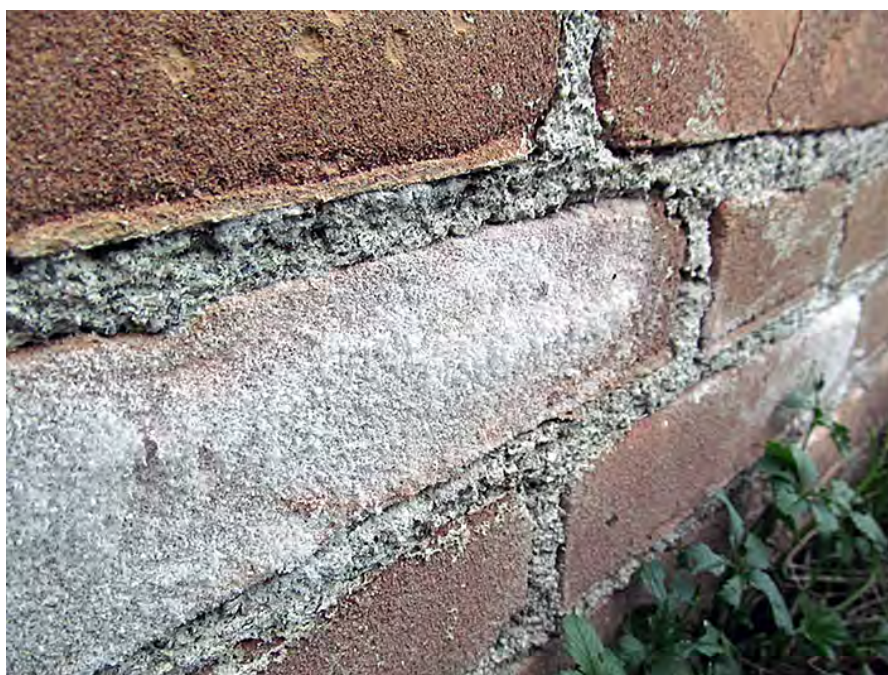
Figura 1.11: Efflorescenza aghiforme su mattone in laterizio
