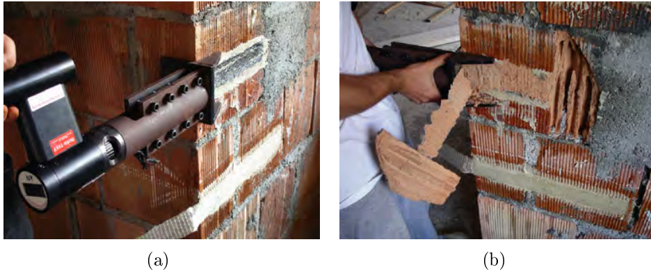
Figura 2.34: Shear-tearing test su edificio in muratura: (a) attrezzature; (b) modalità di rottura Olivito e Zuccarello (2008)
