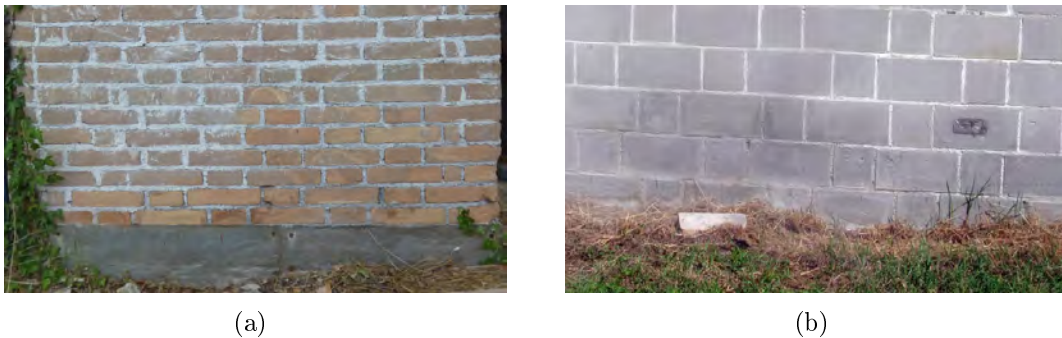
Figura 3.9: Degrado da risalita capillare, pareti in laterizio (a) e in pietra (b)
