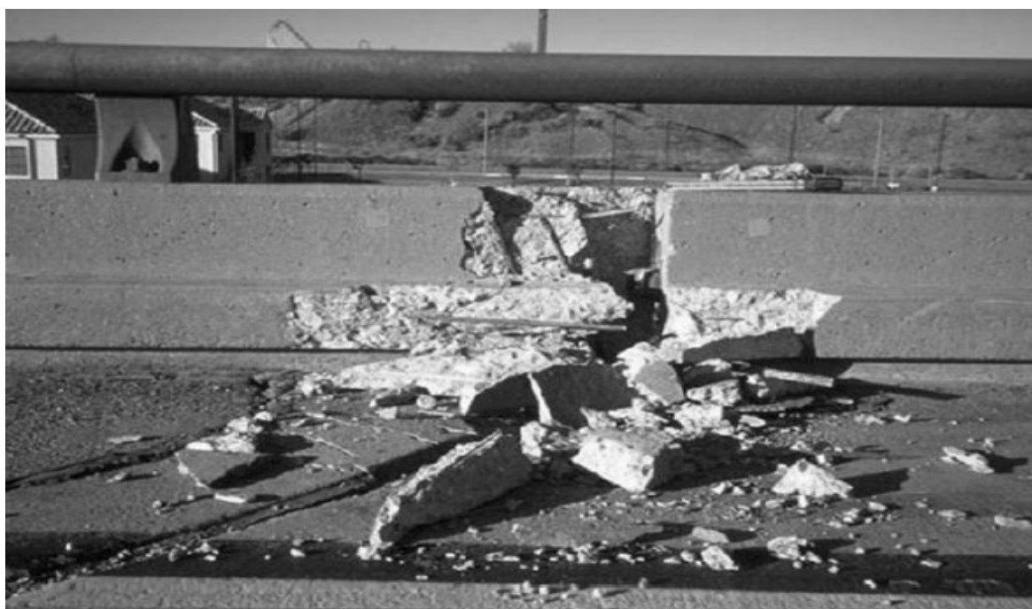
Figura 10 - Martellamento tra due sezioni dell'impalcato
