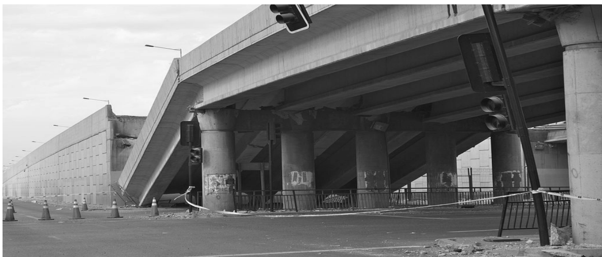
Figura 8 - Perdita d'appoggio dell'impalcato
