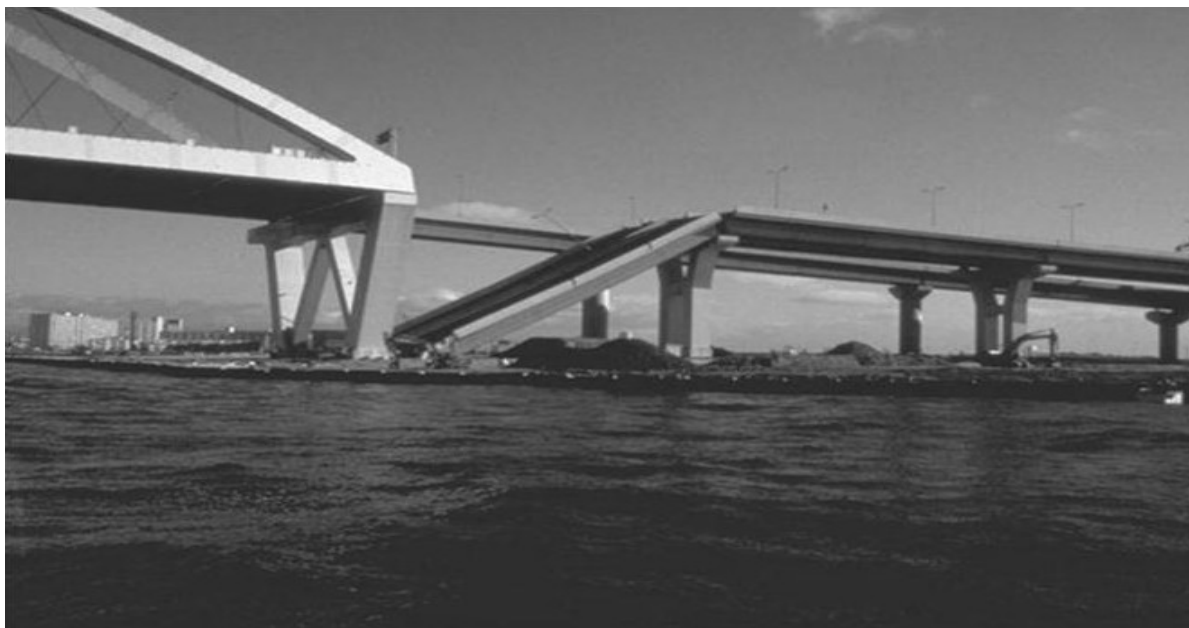
Figura 50 - Esempio di perdita d'appoggio dell'impalcato con resistenza della sovrastruttura
