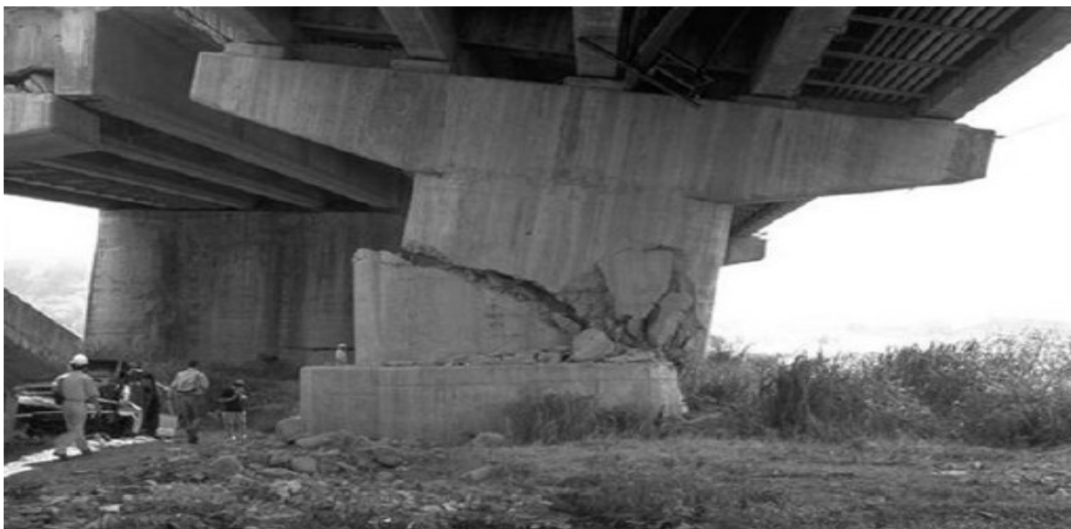
Figura 13 - Rottura per taglio di una pila
