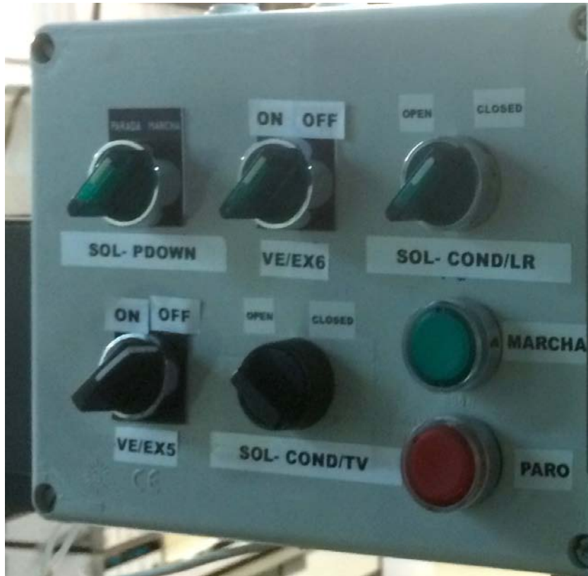
Fig. 6.1 - Uno dei pannelli di controllo del prototipo.
