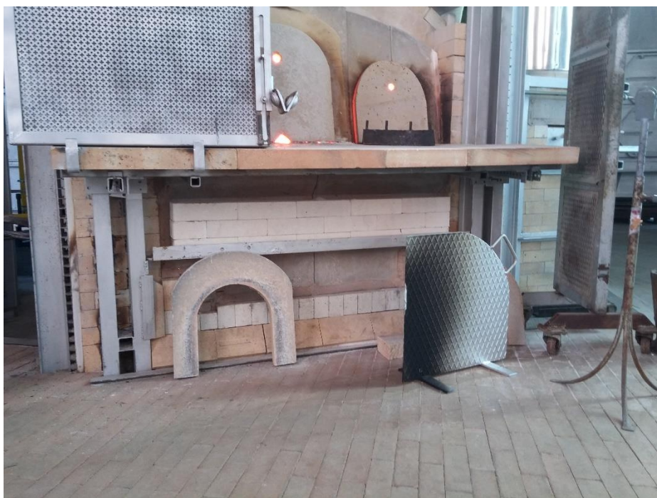
Figura 68 - Parte frontale inferiore, da notare suola in materiale refrattario e sistemi per lo scarico del vetro in caso di rottura del crogiolo
