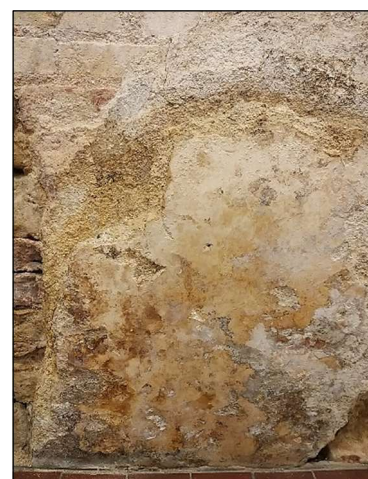
Figura 3.10. Lacerto di intonaco del muro continuo. Foto Autore.
