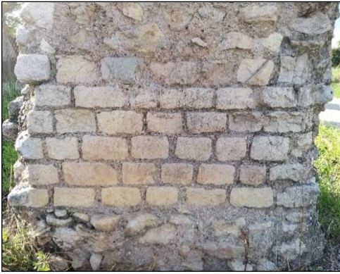
Figura 3.17. Loc. Lobia: porzione di paramento in opus vittatum di un pilastro nella zona più a Sud, che comincia dopo la fondazione in opera cementizia. Foto Autore.
