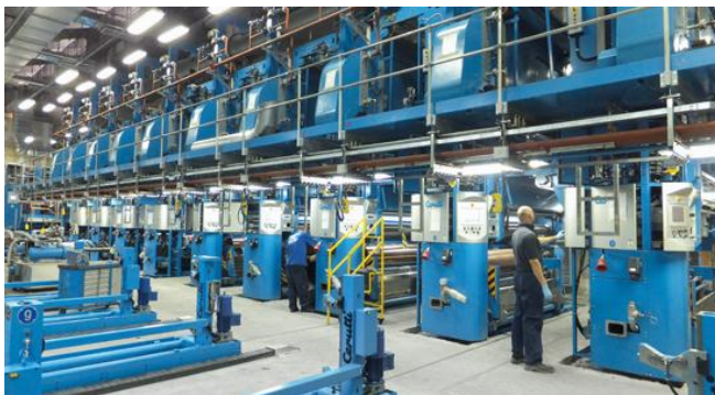
Fig. 22 - Realizzazione di Aurora tramite IndraMotion
