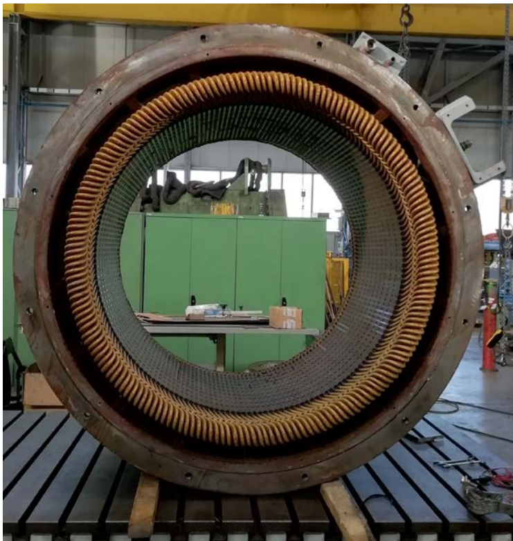
Fig. 8-32 Vista frontale dello statore della macchina BBC
