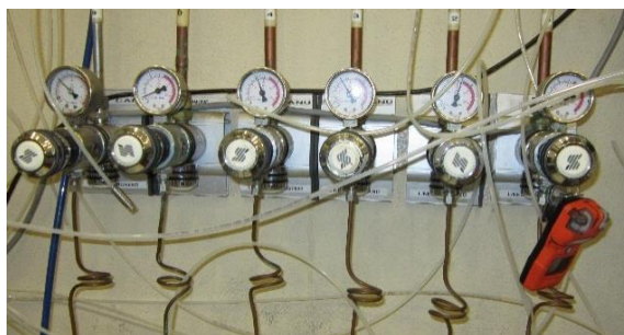
Figura 2.22: Riduttori di pressione a muro.
