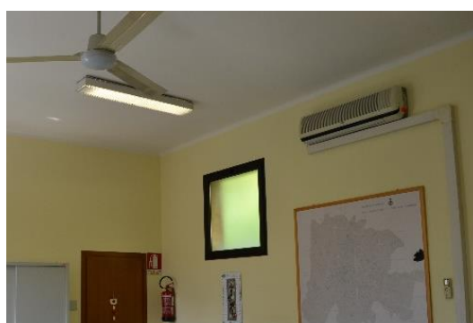
Figura 5.78 Estintore e sistema di condizionamento dell'aria
