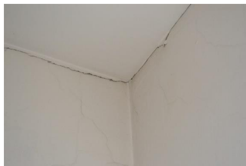
Figura 5.47 Fessura parete solaio
