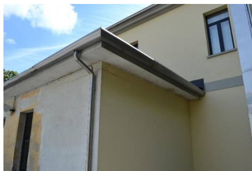
Figura 5.24 Lesione orizzontale dovuta alla presenza di un cordolo in c.a.
