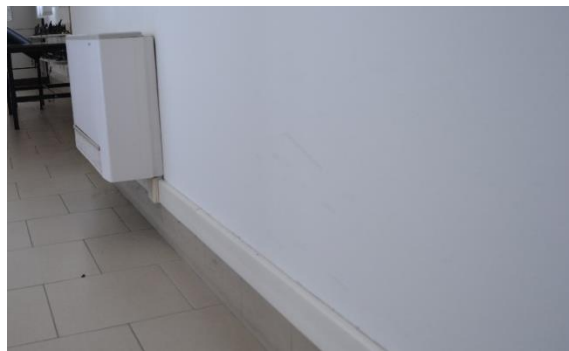
Figura 5.66 Sistema di riscaldamento al piano terra della Loggia e del complesso retrostante
