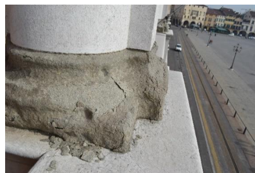
Figura 5.41 Degrado base colonna
