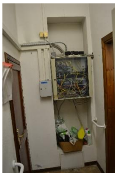
Figura 5.67 Quadro elettrico e impianti a vista
