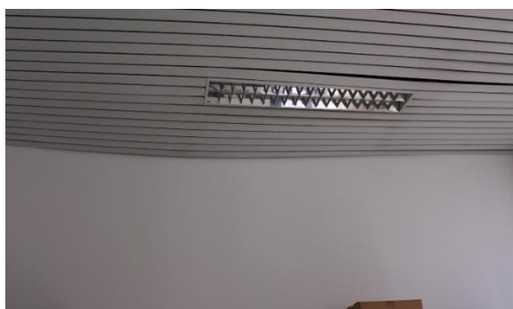
Figura 5.70 Inflexione del controsoffitto dovuta a sovraccarichi
