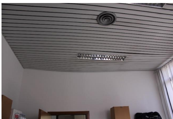
Figura 5.20 Controsoffitto inflesso a causa di sovraccarichi verticali concentrati
