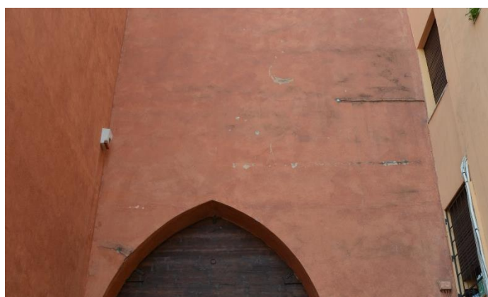
Figura 5.54 Alterazione cromatica-prospetto Loggia2
