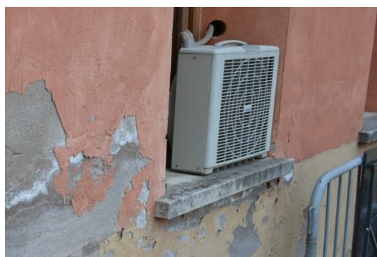
Figura 5.74 Unità esterna del sistema di condizionamento
