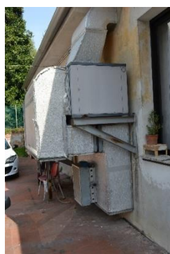
Figura 5.73 Centrale trattamento aria
