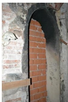
Figura 5.06 Apertura tamponata nel sottoscala
