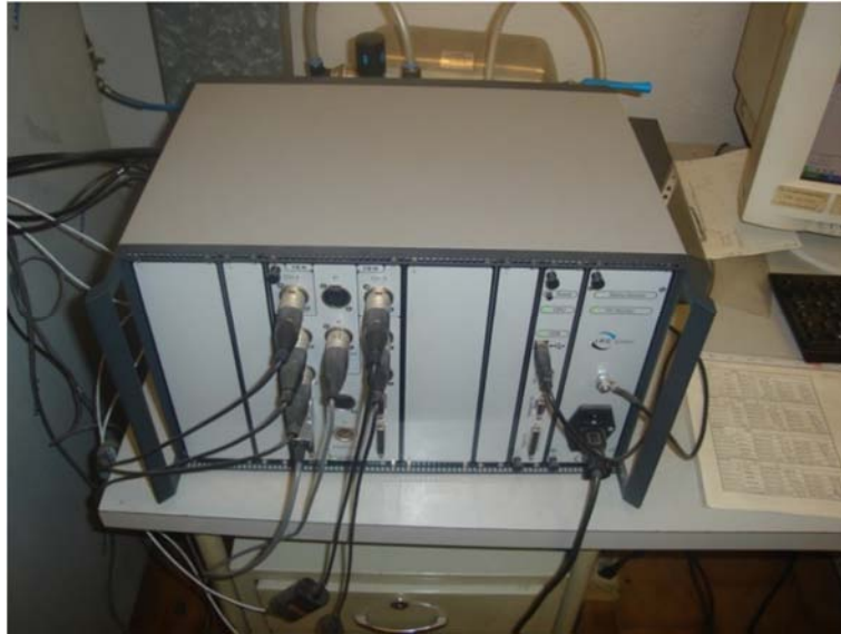
Figura 9.25 Stazione elettrica per l'acquisizione dei dati
