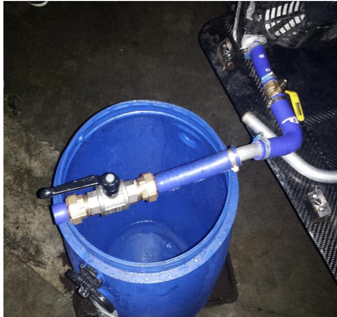
Fig. 12 e 13 : impianto per misurare la portata della pompa centrifuga
