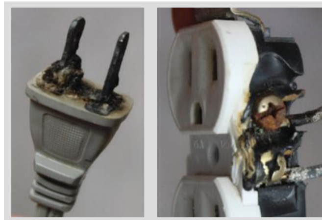
Fig. 2.2a (sinistra): connettore danneggiato a seguito di un sovraccarico avvenuto in una prolunga
