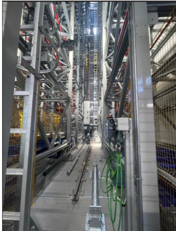
Figura 23-Traslo elevatore e vani torre porta bobine
