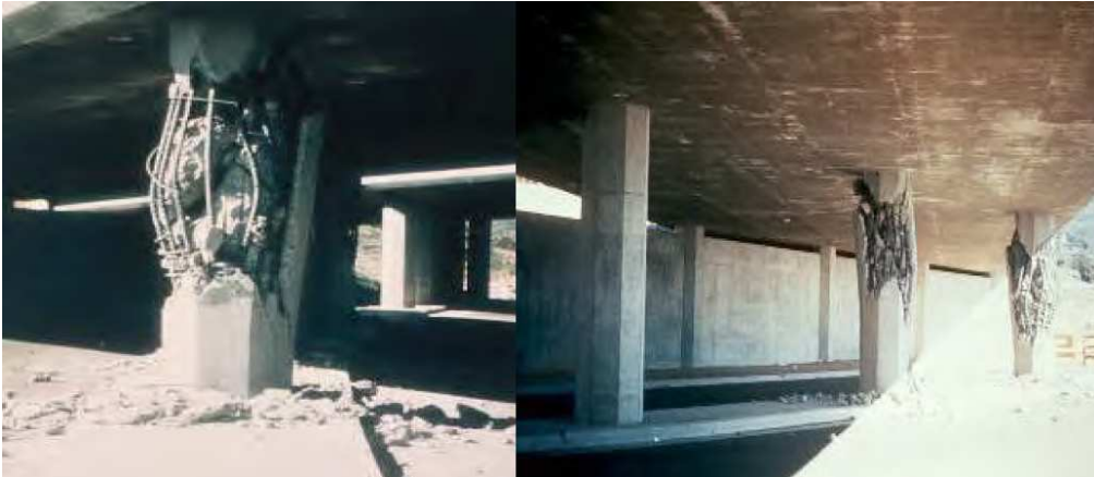
Fig. 1.2 Esempio di rottura a taglio di pile di ponti stradali, terremoto di San Fernando, USA 1971
