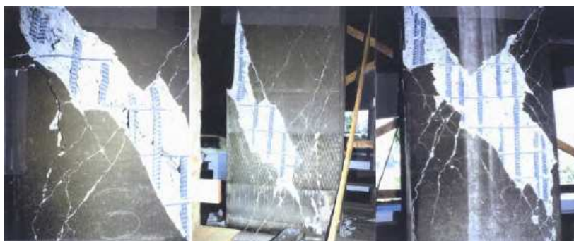
Fig. 1.1 Esempio di rottura a taglio, terremoto di Whittier Narrows, USA 1987
