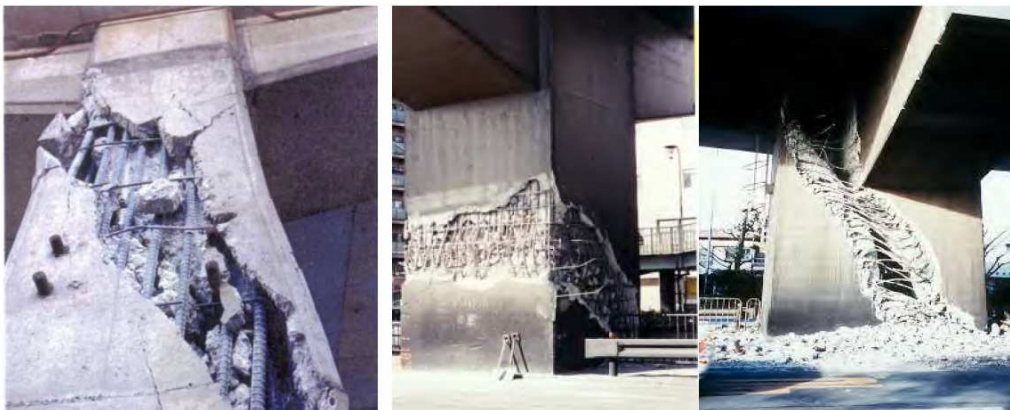
Fig. 1.4 Esempio di rottura a taglio di pile di ponti stradali, terremoto di Kobe, Giappone 1995
