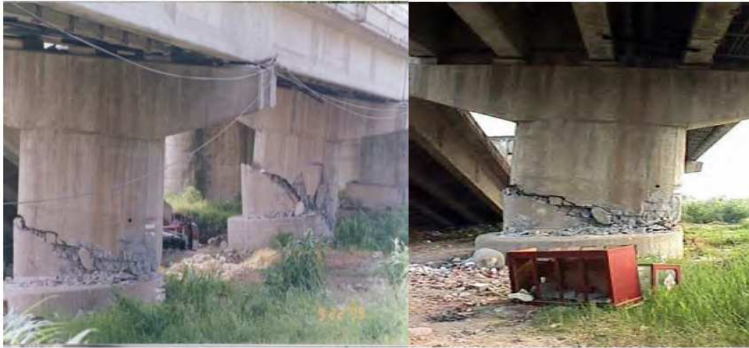
Fig. 1.5 Esempio di rottura a taglio di pile di ponti stradali, terremoto di Taiwan, 1999
