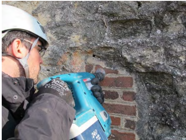
Fig. 9.18 – Foto dell'installazione di un accelerometro
