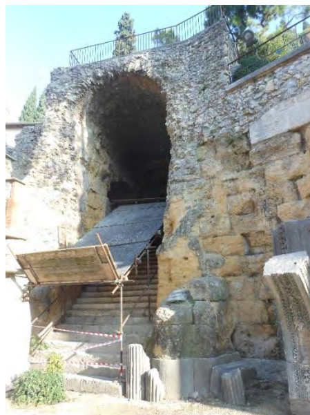
Fig. 1.27– La scala che aggira la cavea ad oriente, coperta da volta a botte, foto 2014
