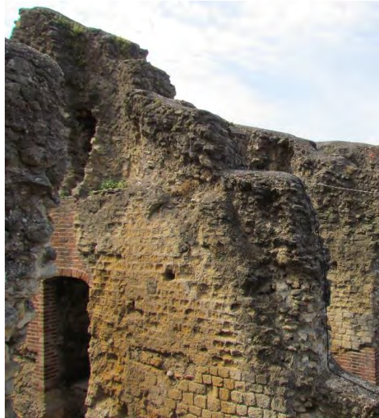
Fig. 4.40 – Setto della zona Chiesa con zone di distacco del paramento esterno rimanente
