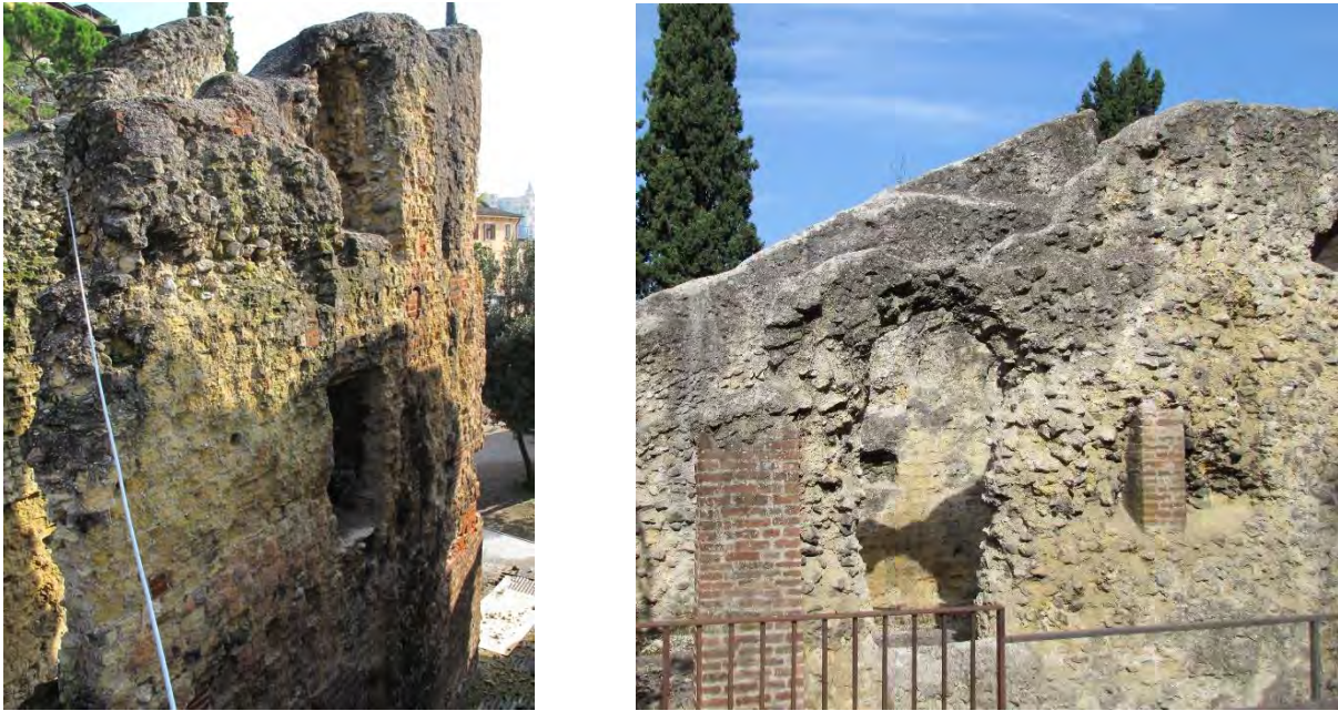
Fig. 4.47 e 4.48 – Le foto indicano come i setti sia in zona Chiesa (prima foto) che in zona Museo (seconda) siano fortemente degradati superiormente. Gran parte del paramento esterno è crollato e il nucleo interno è scoperto e sottoposto all'azione degli agenti esterni.
