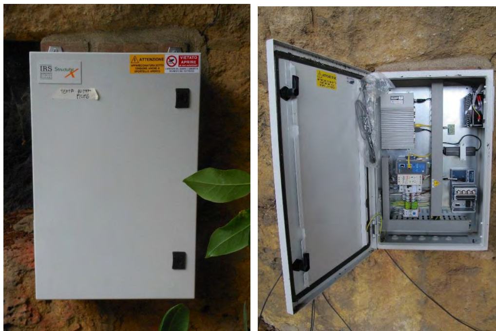
Fig. 9.3 - Centralina di acquisizione (master) della zona Scena (chiuso e aperto)
