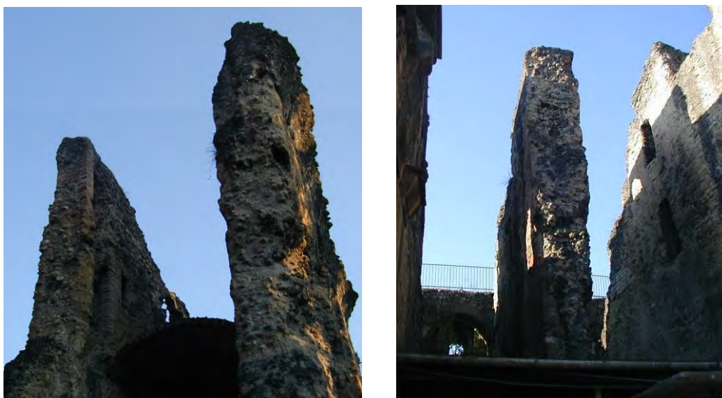
Fig. 5.15 – Setti murari nella zona Ovest (A) ed Est (B) del Teatro Romano, oggetto di test dinamici
