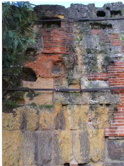
Fig. 4.41 – Porzione della scena con presenza di alterazioni cromatiche ed efflorescenze
