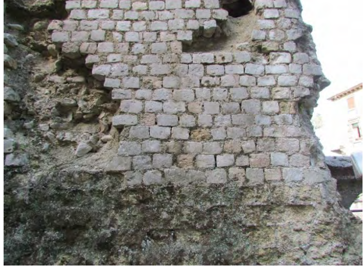
Fig. 4.50 – Foto di uno dei prospetti di A2: in alcune zone è ancora presente il paramento esterno, mentre in altre vi sono lacune profonde.
