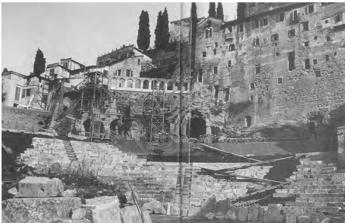
Fig. 1.40– Lavori nella cavea con le impalcature servite per la ricostruzione della loggetta, foto 1912 [da “Il teatro e gli spettacoli”]. Da notare le passerelle disposte a zig zag per facilitare il trasporto delle pietre e l’assenza del secondo meniano.
