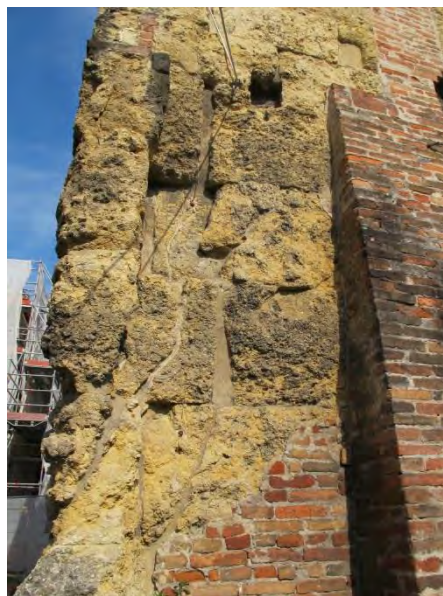
Fig. 4.39 – Parte dell'arco di ingresso puntellato con evidente disgregazione
