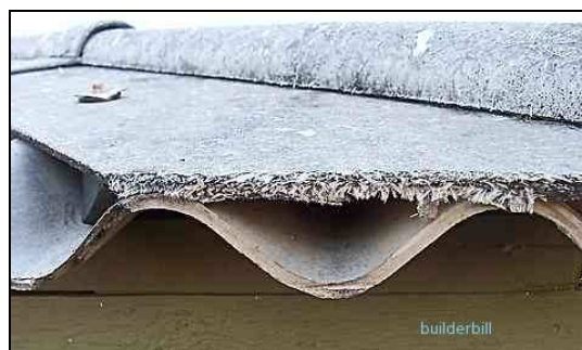
Figura 2.2. Esempio classico di copertura in amianto.
