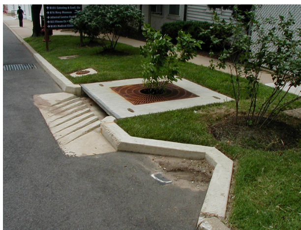
Immagine n°8: Tree box filter: particolare di captazione
