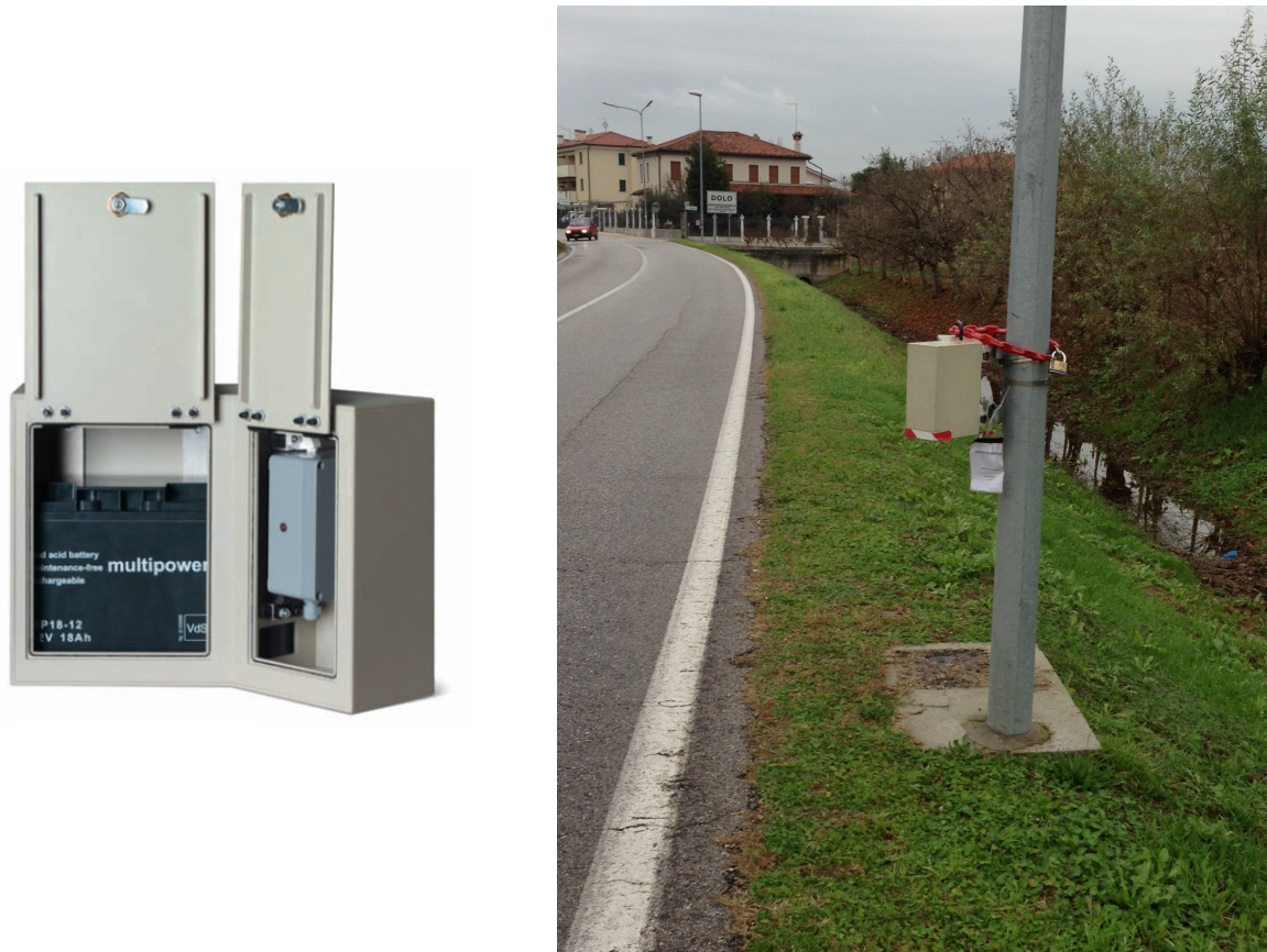
Fig. 3.3 - Viacount: foto del dispositivo radar e posizione della corretta istallazione.
