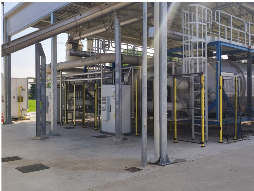
Essiccazione meccanizzata : BIODRYER
