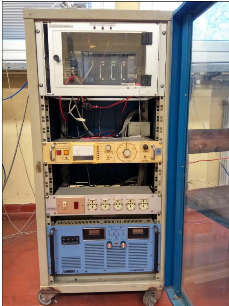
Figura 3.7: rack presente alla destra del forno. La parte in alto è costituita dal PLC di controllo, all'interno del quale è presente una scheda di memoria nella quale vengono caricate le rampe di comando e vengono salvati i dati in output, mentre nella parte bassa è presente l'alimentatore.
