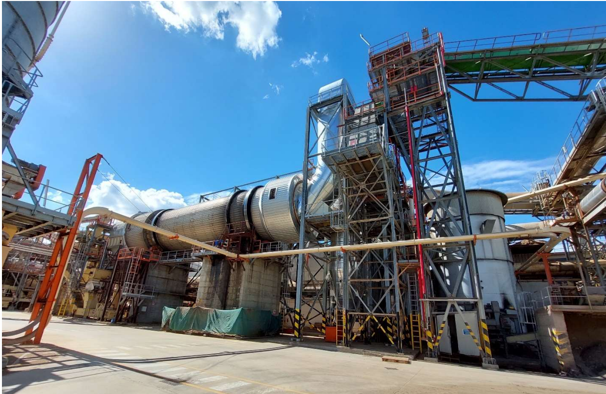
Figura 5.5 – Foto dell'impianto di essiccazione, vista ovest. Nell'immagine sono visibili la camera di combustione, a destra, e l'essiccatoio a tamburo rotante, a sinistra.
