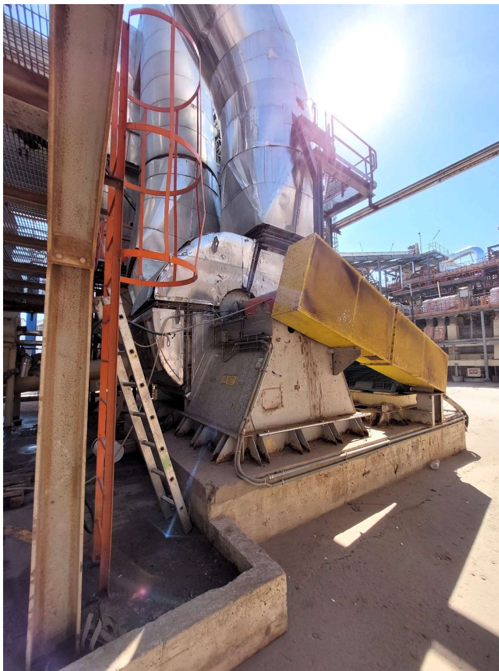
Figura 5.9 – Foto dell'esterno del ventilatore dell'essiccatoio. Nell'immagine è visibile l'involucro all'interno del quale è ubicato il ventilatore e la gabbia gialla di protezione che ricopre le cinghie trapezoidali che collegano l'asse della ventola e quello del motore.
