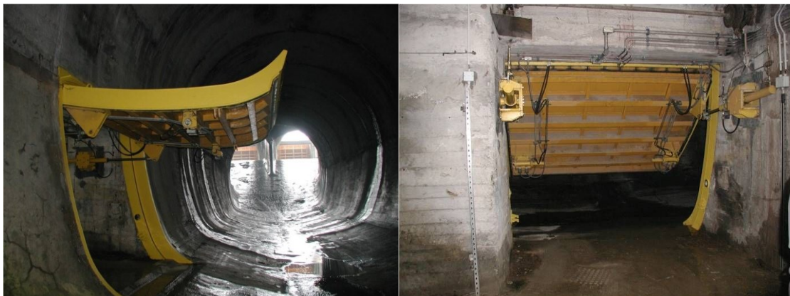
Figura 33: Porte a tenuta stagna utilizzate per l'ingresso dei mezzi manutentivi.
