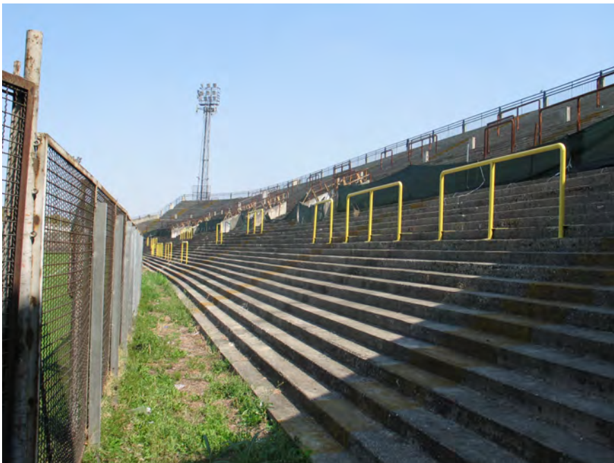
Figura 6.1.3: Stato attuale della Tribuna Est-Foto interno 2. Fonte: Settore Infrastrutture e Trasporti del Comune di Padova
