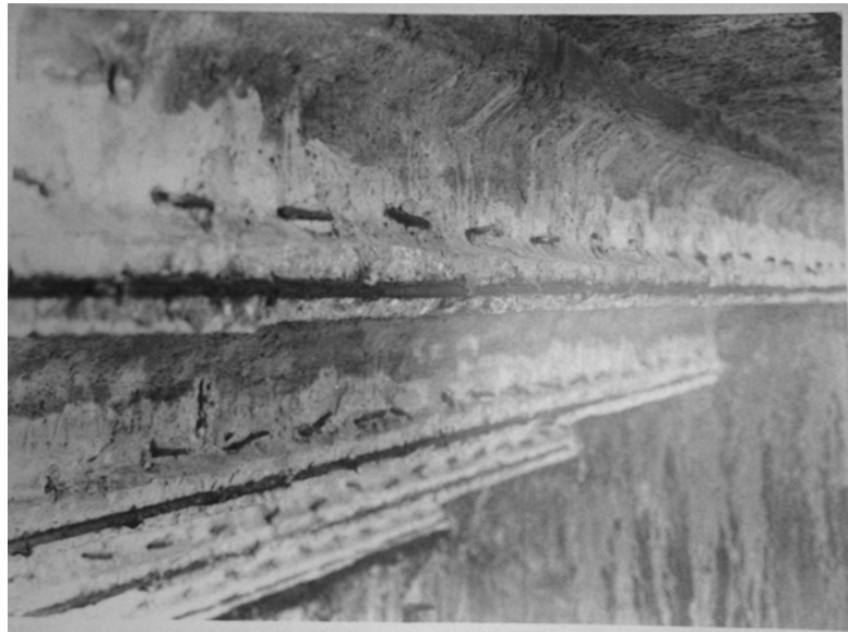
Figura 6.6.2: Stato di deterioramento dei travetti in una fotografia da sotto la Tribuna Est. Fonte: [18]
