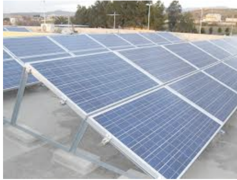
Figura 3.1 – Campo fotovoltaico con struttura a cavalletto
