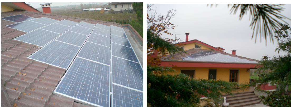
Figura 4.9 – Impianto sulla falda
