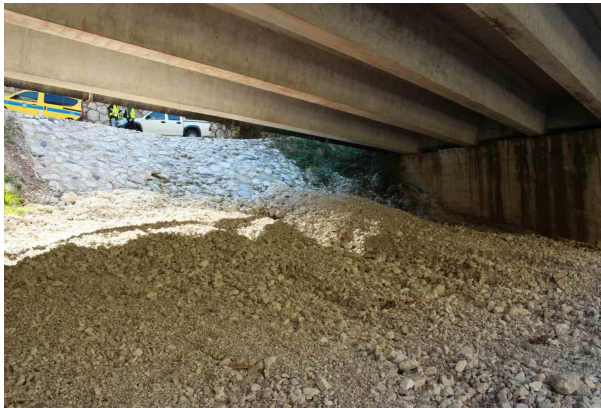
Figura 4.3.2.4.1: Vista del materiale detritico depositato al di sotto del viadotto
