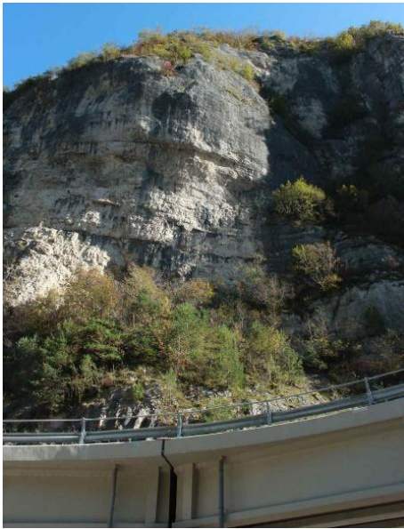
Figura 4.6.2.4.1: Vista della porzione di versante a monte del viadotto caratterizzato da rischio di crolli
