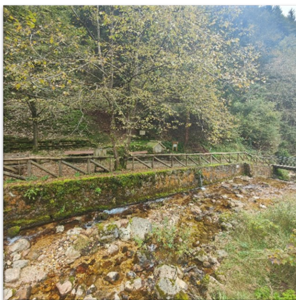
Figura 13 Torrente Fraselle: infiltrazioni laterali lungo le sponde dell'alveo, Giazza, Selva di Progno (VR), Foto: Tolin T.
