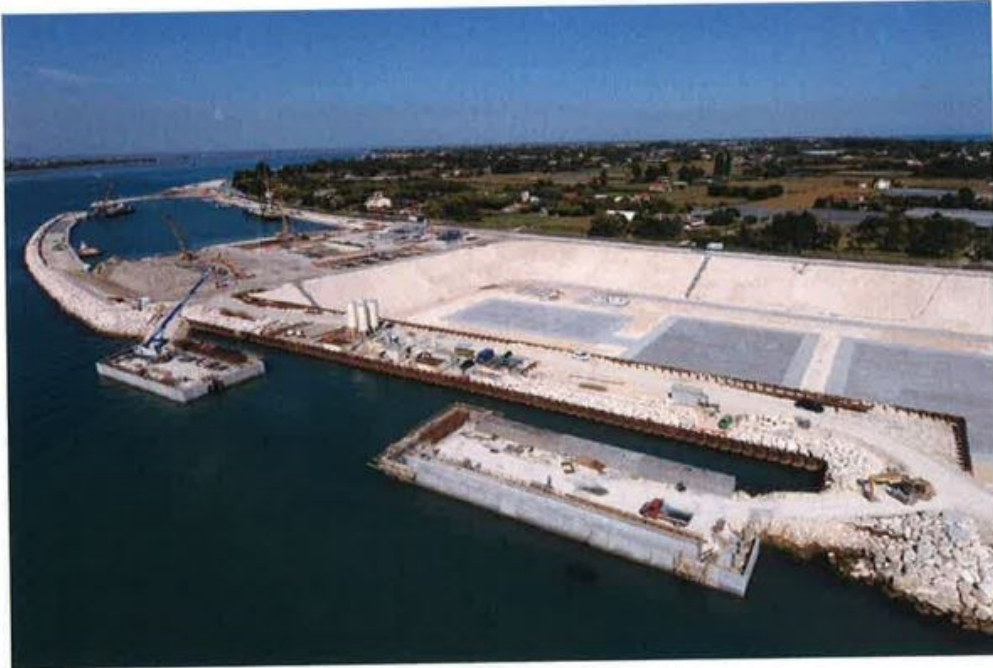
Figura 3.9: Vista delle tura di Lido Treporti (Ottobre 2008); estratto dagli elaborati grafici AS BUILT.
