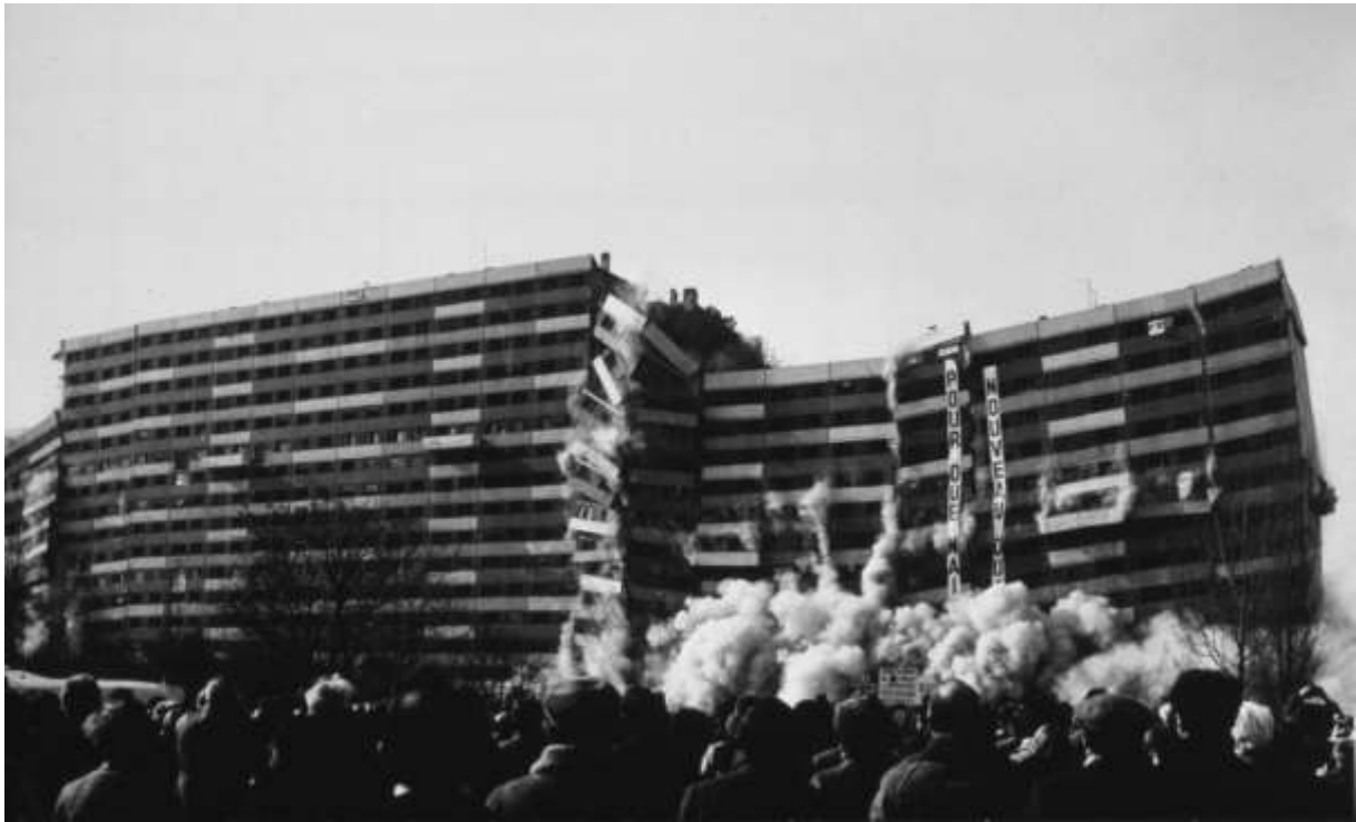
Fig. 6 : Cité des 4000 à la Courneuve, démolition de l’immeuble Debussy, le 18 février 1986 (Image tirée de https://etudesphotographiques.revues.org/3383#bodyfn49 ).
