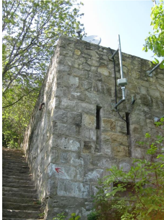
Figura 10: Struttura in cemento armato e muratura ospitante la stazione TEOL
