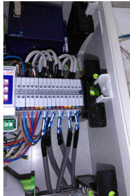
Figura 3.22 - Particolare dell'interconnessione della morsettiera in Modbus con l'acquisitore Ewon.
