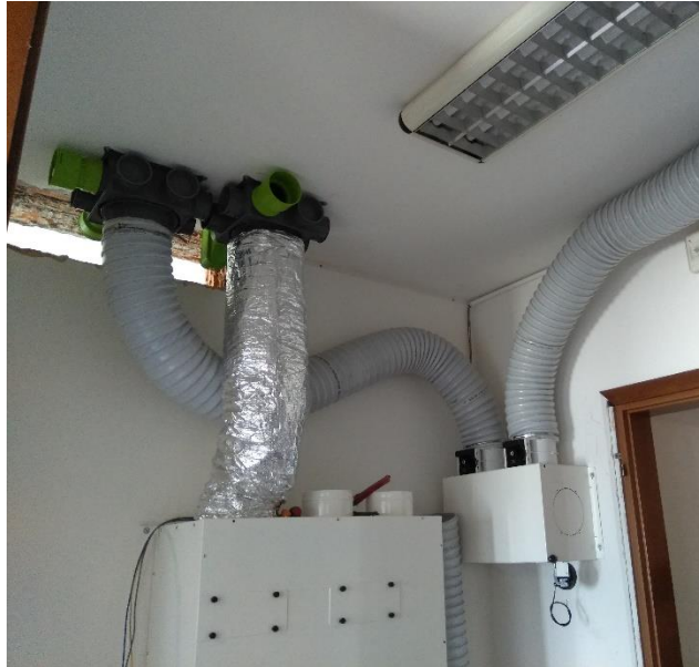
Fig.3.18 - Ancoraggio dei minibox di distribuzione in mandata Camera ed estrazione aria viziata Bagno e Cucina. Si nota anche il fissaggio del tubo insonorizzato collegato all'EoS e la serranda bizona a muro da cui partono le tubazioni di mandata.
