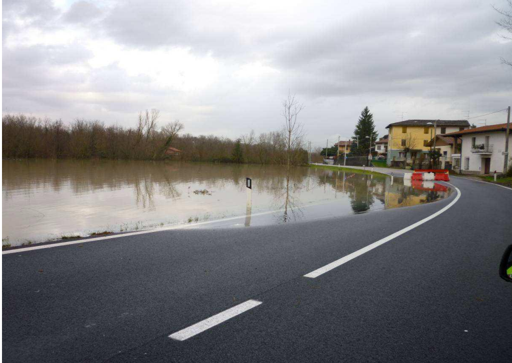
Fig.13. Evento alluvionale del 21 - 25 Dicembre 2009: fase iniziale dell'allegamento della S.P. 8 a Poggio Terza Armata (fonte: Protezione Civile FVG, 2009)
