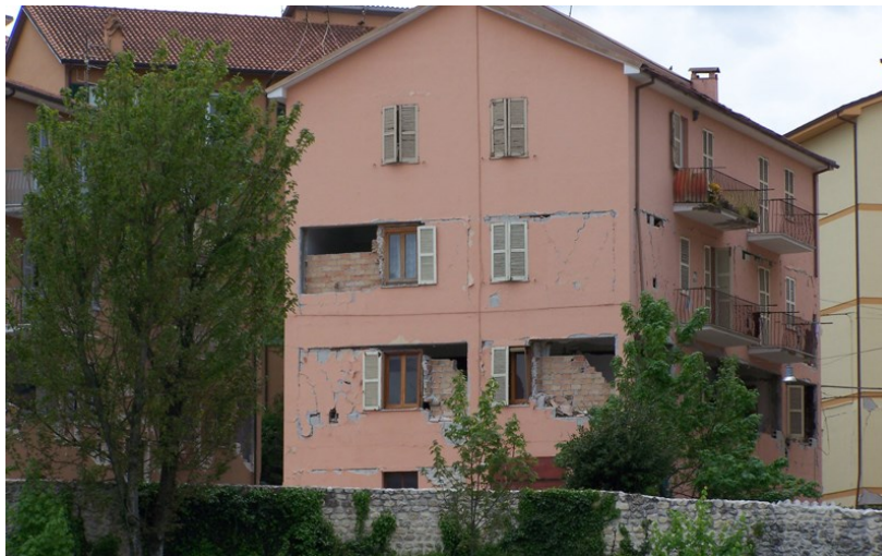
Figura 2.1. Esempio di espulsione delle tamponature esterne in un edificio in c.a.
