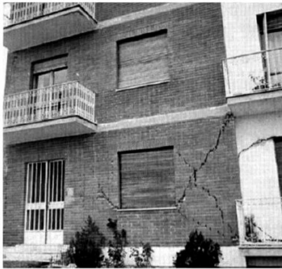
Figura 1.24. Fessurazione causata dall'interazione tra pannello e presenza di aperture
