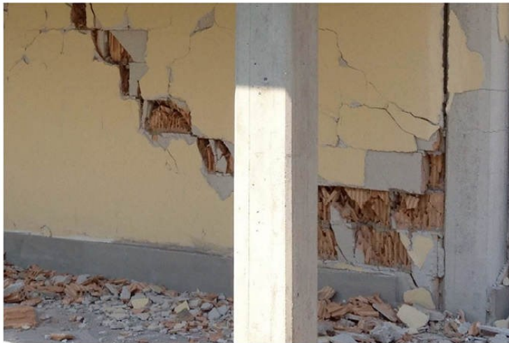
Figura 1.14. Esempio di danneggiamento per schiacciamento degli spigoli di un tamponamento in muratura
