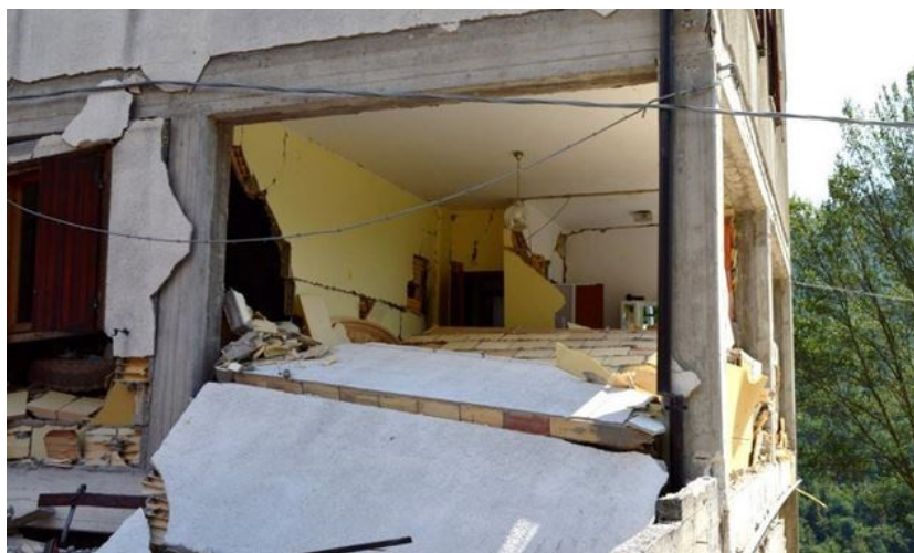
Figura 1.17. Collasso fuori piano di tamponamenti in muratura
