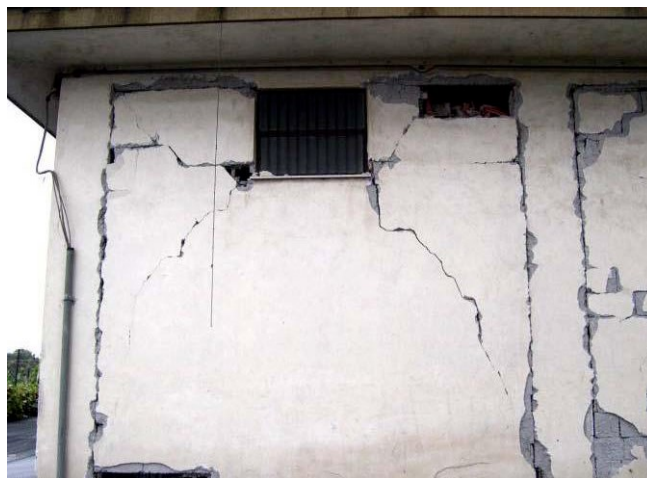
Figura 1.11. Esempio di fessurazione diagonale in presenza di aperture
