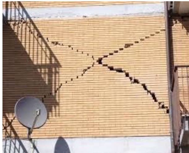
Figura 1.10. Esempio di fessurazione diagonale del tamponamento
