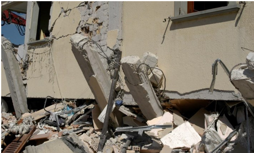
Figura 1.4. Pilastri collassati in corrispondenza del piano soffice durante il terremoto ad Amatrice, 2016
