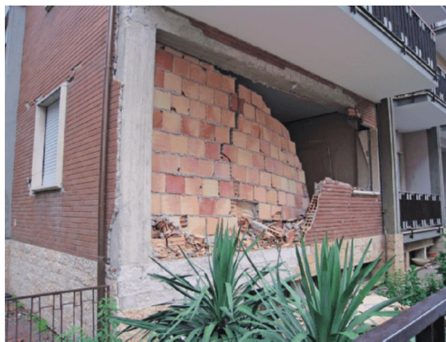
Figura 1.16. Esempio di espulsione fuori piano dei tamponamenti in muratura a causa di un evento sismico
