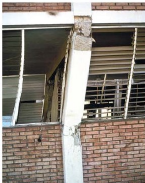
Figura 1.5. Pilastro corto: rottura a taglio per effetto della tamponatura parziale
