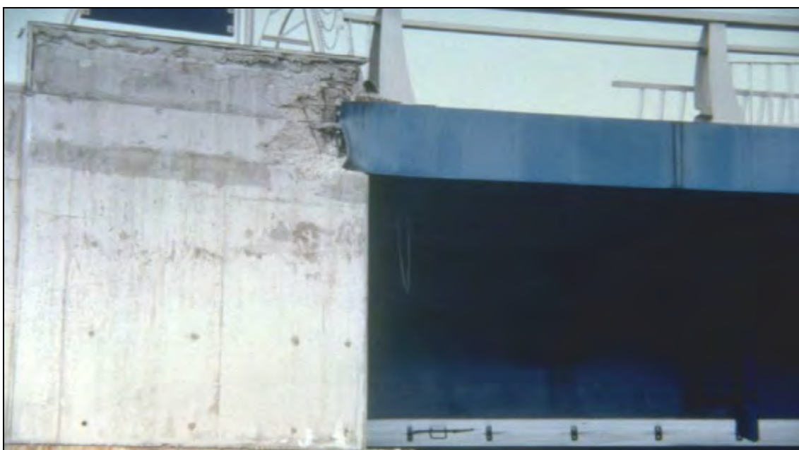
Figura 2.4 - Fenomeno di martellamento in corrispondenza della spalla (terremoto di Kobe, 1995).
