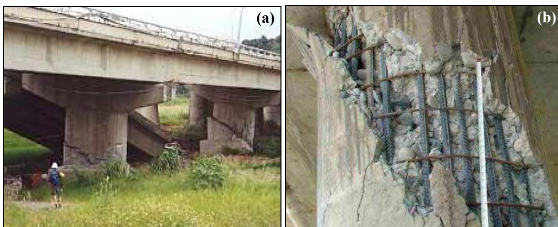
Figura 2.11 - (a) Rottura per taglio delle pile (terremoto di Chi Chi, Taiwan, 1999); (b) classica rottura per taglio di una pila da ponte.
