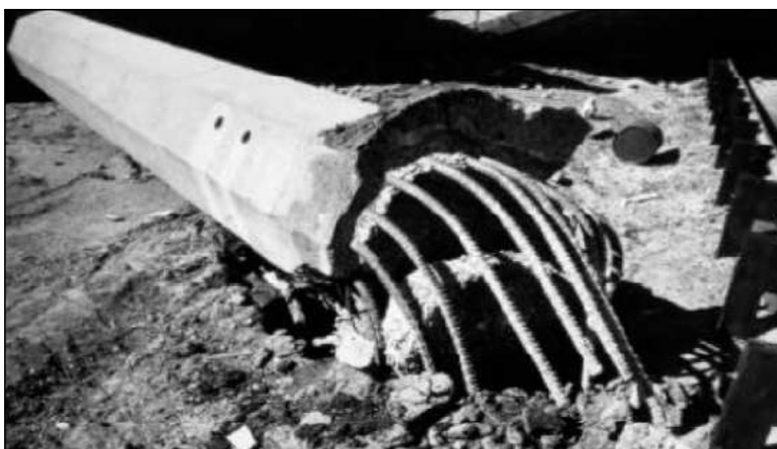
Figura 2.13 - Rottura per insufficiente ancoraggio delle barre nelle fondazioni (Golden State Freeway, terremoto di San Fernand, 1971).
