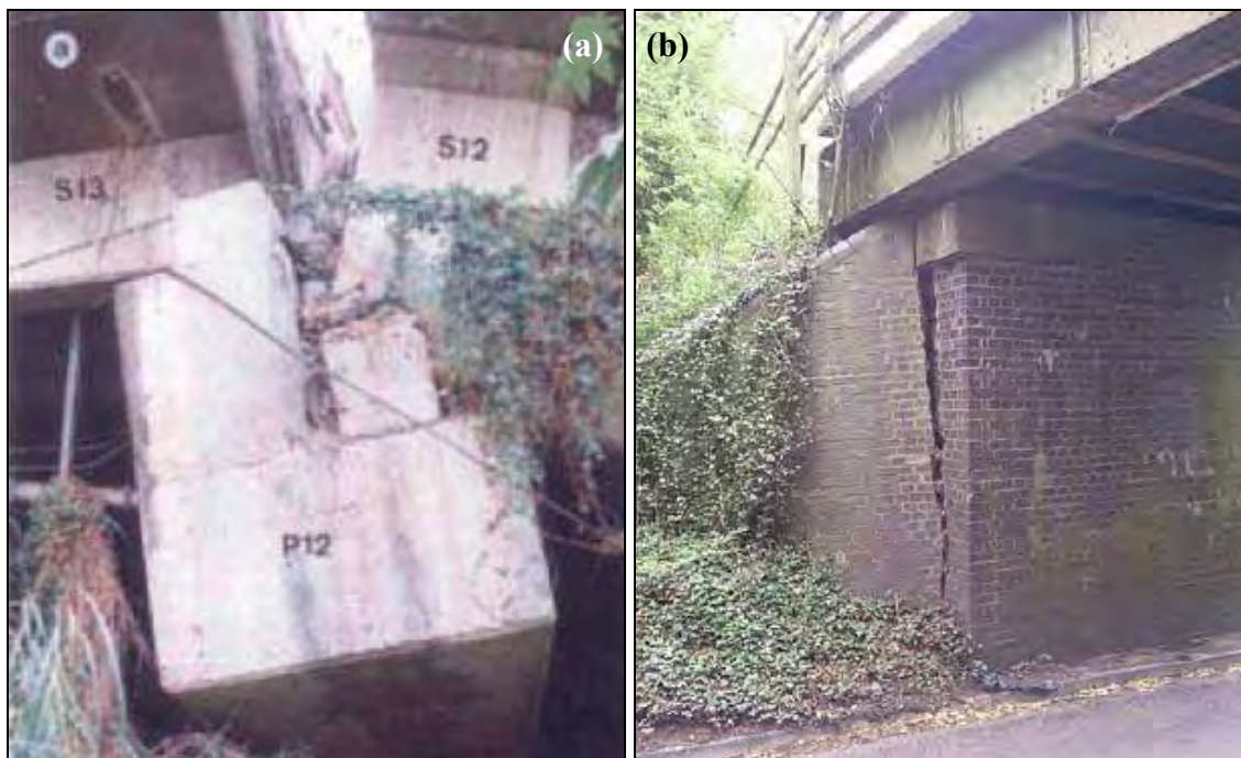
Figura 2.17 - Rottura delle spalle: (a) Changgan Bridge (terremoto di Chi Chi, Taiwan, 1999); (b) Three Cherry Trees Lane Bridge.
