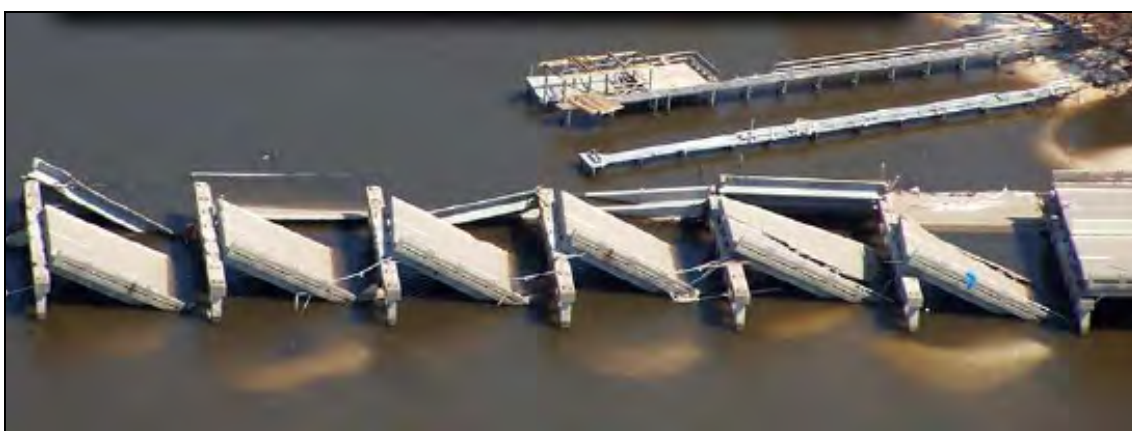
Figura 2.2 - Tipico collasso dell'impalcato per perdita di appoggio (terremoto di Niigata, Giappone, 1964).
