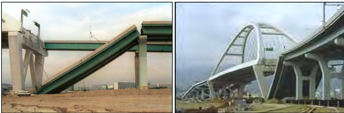
Figura 2.1 - Perdita di appoggio e rottura dei dispositivi di collegamento di un viadotto a campate in semplice appoggio (Nishinomiya-ko bridge, terremoto di Kobe, Giappone, 1995).
