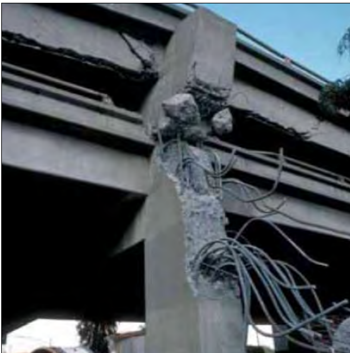
Figura 2.14 - Rottura per insufficiente ancoraggio delle barre dei traversi (Cypress Viaduct, terremoto di Northridge, 1994).
