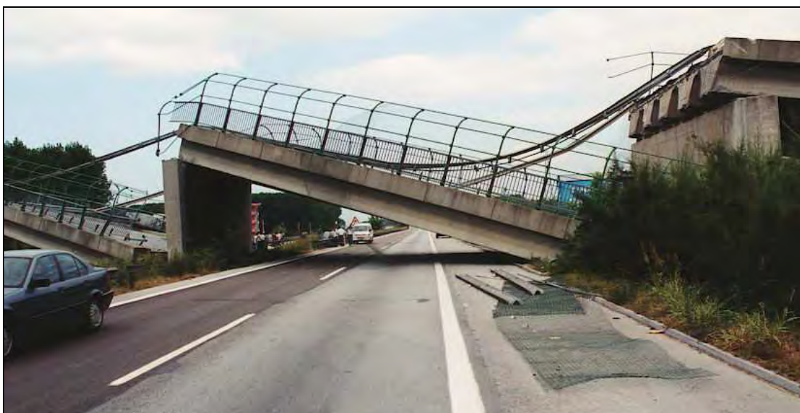
Figura 2.3 - Perdita di appoggio di un ponte dopo un terremoto in Turchia.
