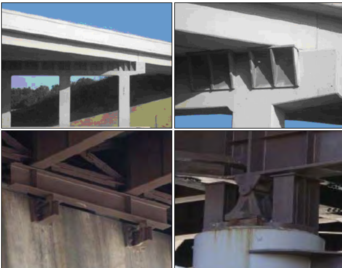
Figura 2.21 - Intervento di allungamento delle zone di appoggio dell'impalcato per ponti in semplice appoggio mediante selle metalliche.
