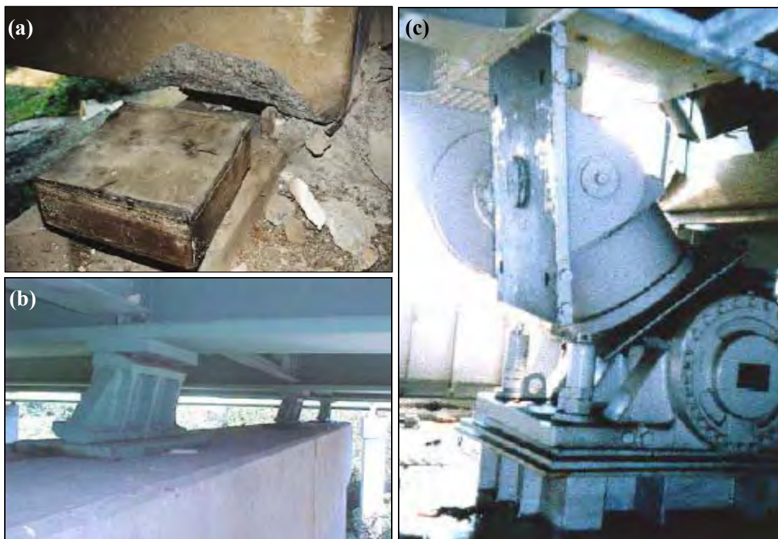
Figura 2.18 - (a) e (b) Dispositivi di appoggio danneggiati; (c) collasso di un dispositivo di smorzamento viscoso rotante, dovuto a eccessivi spostamenti (Higashi-Kobe Bridge, terremoto di Kobe, 1995).
