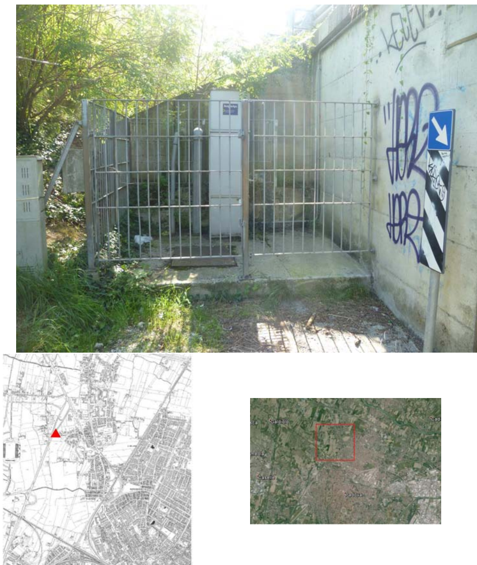
Figura 10: stazione di sollevamento di via Cignaroli - tangenziale
