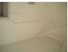
1F| Lesioni verticali sulla parete che proseguono sulla volta
