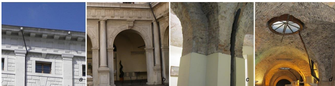
Figura 8.8: a) pluviali nella facciata sud del palazzo sono stati aggiunti in un secondo tempo; b) le gronde del chiostro dorico attraversano il solaio di calpestio e proseguono al piano inferiore; c) scanalatura verticale nella muratura della sala espositiva; d) sistema di raccolta delle acque meteoriche dal lucernario.
