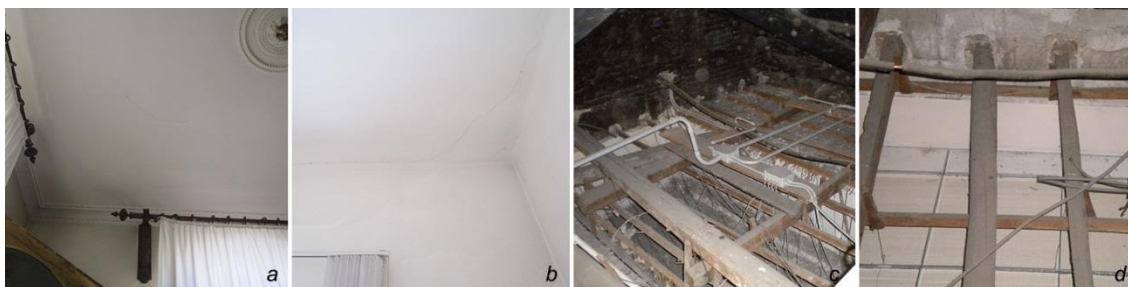
Figura 7.47: a-b) fessurazioni su controsoffitto in arelle, Ala Moschini ; c-d) degrado in alcuni dei controsoffitti in arelle al terzo piano di Palazzo Moroni .
