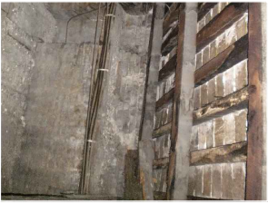
6D) Marescenza promossa da infiltrazioni d'acqua
