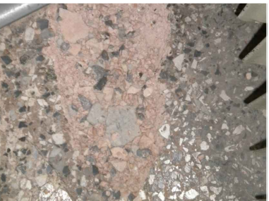
20D Disgregazione dei materiali d'arpoio ai quali sono state risarcite le canalizzazioni per gli impianti nel pavimento
