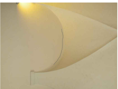
8F| Lesione sulla parete in corrispondenza della volta
