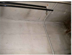
3F Lesione verticale in corrispondenza dello spigolo
