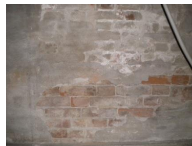
Figura 7.25: La tessitura muraria dell'Ala Moschini in un punto di degrado dell'intonaco.
