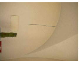
3D Fessurazione dell'intonaco in corrispondenza degli impianti
