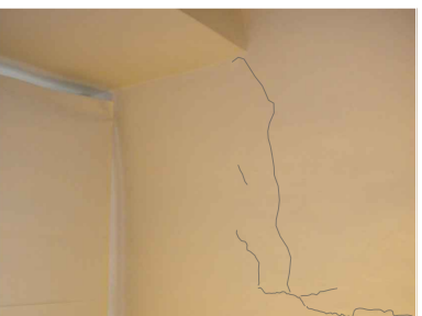
15F | Lesione della volta in corrispondenza di un'apertura
