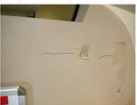
1D Fessurazione dell'intonaco in corrispondenza degli impianti
