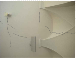
4F| Lesioni sulla volta che proseguono sulla parete
