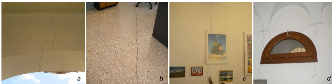
Figura 7.38: a) lesione in chiave di un arco del chiostro; b) lesione sul pavimento in un ufficio; c) lesione sulla parete; d) fessure da concentrazione di tensioni in corrispondenza di un'apertura.
