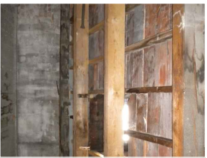
3D Infiltrazioni d'acqua e macchie sull'intonaco parietale
