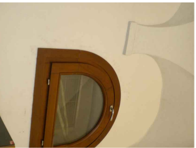
6D| Degrado dell'intonaco attorno alla finestra provocato dall'umidità
