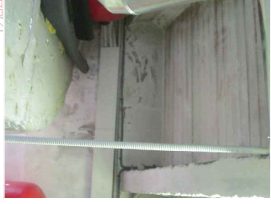
4D1 Distacco dell'intonaco promosso dall'umidità
