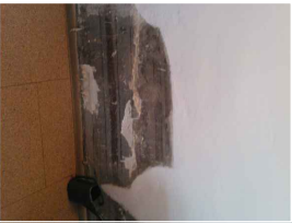
2D Distacco dell'intonaco su affresco
