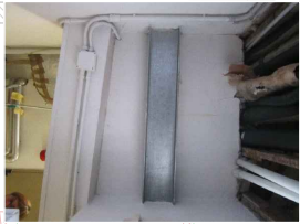
3D1 Impianti non opportunamente fissati e protetti
