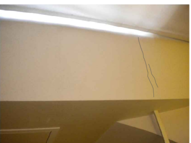
12F | Lesione in corrispondenza delitranc
