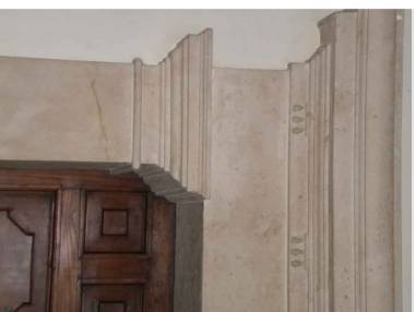
40F Essurazione della pietra nella cornice della porta
