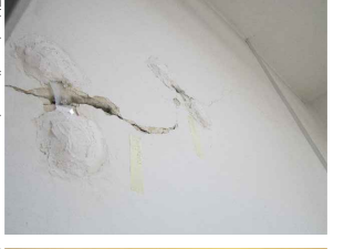
4F | Lesione diagonale passante monitorata con vetri data 30/05/2012
