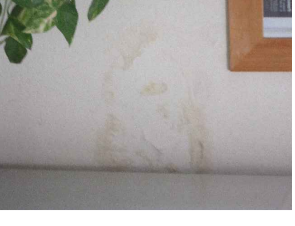
5D | Degrado dell'intonaco promosso dall'umidità
