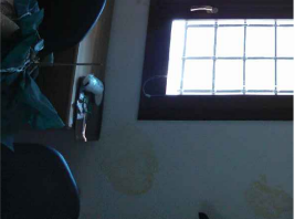
3D Macchie sull'intonaco promosse dall'umidità
