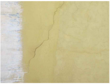
1F| Lesione inclinata che segue l'andamento della scalinata
