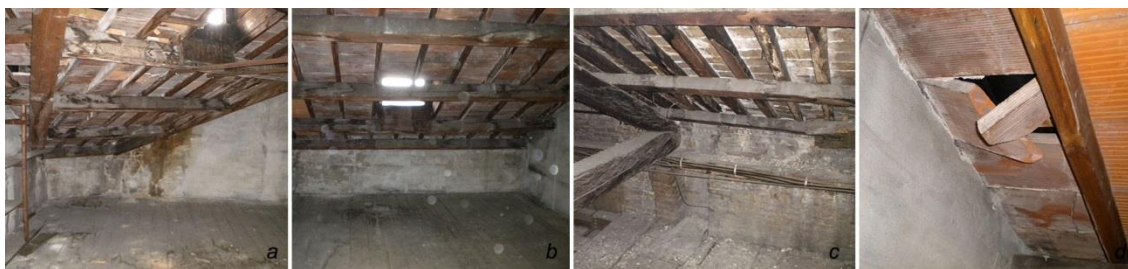
Figura 7.49: a) marcescenza delle travi e patina biologica sulla parete nell' Ala Moschini ; b) deformazione delle travi danneggiate da infiltrazioni; c) marcescenza in copertura della Sala del Consiglio; d) tavella in laterizio danneggiata dell' Ala Moschini .
