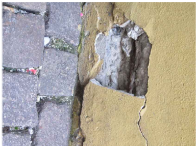
110| Espulsione del copriferro
