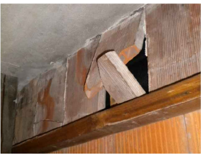
5D Rottura delle tavole di copertura a causa di propagazione di cricche (dilatazioni termiche)
