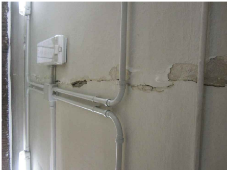
8F1 Lesione su soffitto con distacco di intonaco
