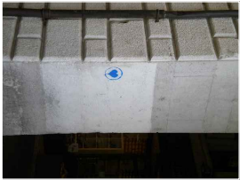
4D) Graffiti vandalici
