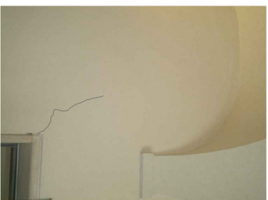
9F| Lesione diagonale sulla parete in corrispondenza di un'apertura
