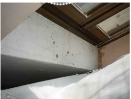
8D Estofazione della pittura muraria e degrado dell'affresco promosso dall'umidità in corrispondenza della finestra
