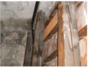
6D Fessure orizzontali disposte longitudinalmente sulle travi. Macchie sull'intonaco parietale
