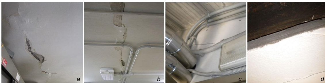
Figura 7.42: a-b) lesioni sul soffitto dell'archivio al terzo piano; c-d) lesioni in corrispondenza del cordolo nella sala impiantistica al terzo piano.
