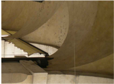
100| Deposito superficiale sulle volte
