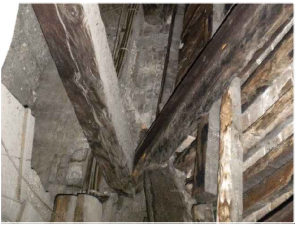
5D) Marescenza promossa da infiltrazioni d'acqua, assottimenti della catena
