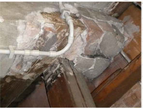
1F Lesione della muratura in corrispondenza dell'appoggio di un puntone di copertura
