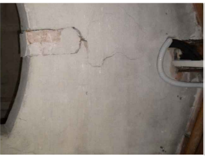
4F Lesione verticale passante in chiave con slittamento di due conci dell'arco
