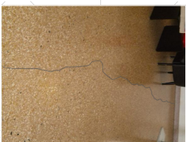
1F Lesione sul pavimento
