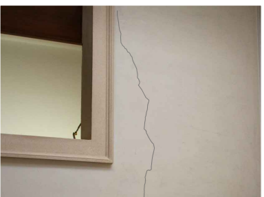
12F| Lesione diagonale passante sopra apertura
