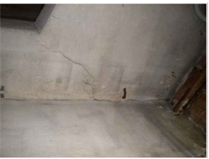
5F Lesione diagonale in corrispondenza dell'imposta dell'arco e lesione verticale in corrispondenza dello spigolo
