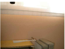
10D Cavillatura dell'intonaco in prossimità di un'apertura
