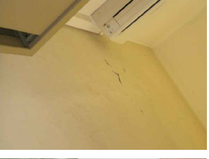
4D | Distacco dell'intonaco
