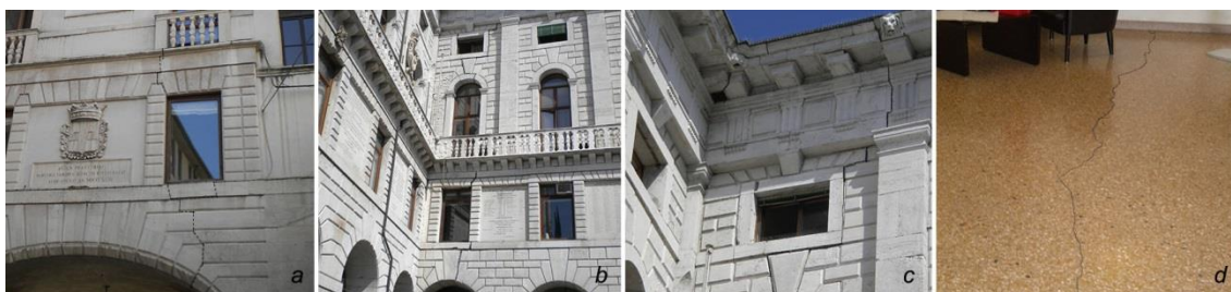
Figura 7.41: a) lesioni ripristinate su Via del Municipio; b-c) lesioni ancora visibili su Piazza delle Erbe; d) fessura sul pavimento della Reception
