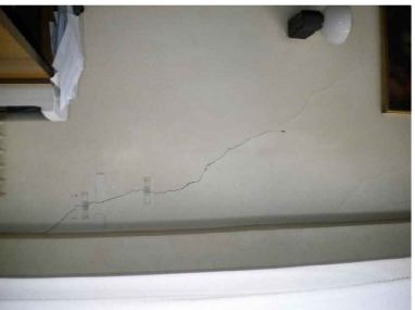
67F Lesione diagonale passante in corrispondenza di uno spigolo monitorata con vetrino
