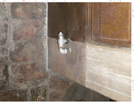
1D Presenza di impianti su superfici affrescate
