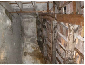
8D Infiltrazioni diffuse sulla copertura, che promuovono un attacco biologico lungo la parete
