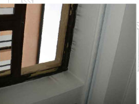
5D Alterazione cromatica dell'affresco promossa da ponte termico e degrado dell'infisso in legno a causa dell'umidità
