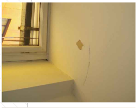
4D1 Distacco dell'intonaco nel controsoffitto
