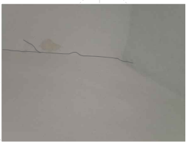
5F Lesione verticale sullo spigolo della parete con distacco di intonaco
