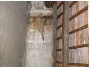
9D Attacco biologico promosso da infiltrazioni lungo la parete
