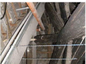
16) Fessurazioni nelle travi
