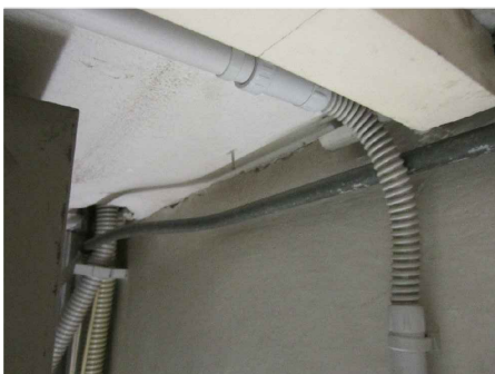
9F1 Lesione sul soffitto in corrispondenza di una parete
