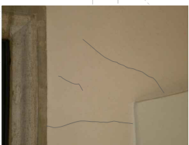
4F Lesione verticale in corrispondenza dell'impalcata della volta
