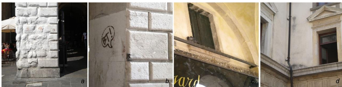
Figura 7.45: a) mancanze su un pilastro in piazza delle Erbe; b) graffito vandalico; c) deposito superficiale nelle volte a crociera del porticato esterno; d) patina biologica nell'intonaco del chiostro dorico.
