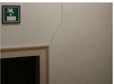
13F| Lesione diagonale passante sopra apertura
