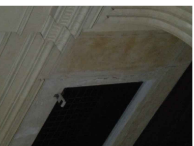
50F Essurazioni dell'intonaco in corrispondenza di discontinuità delle dall'inserimento nelle murature di bocche di aerazione
