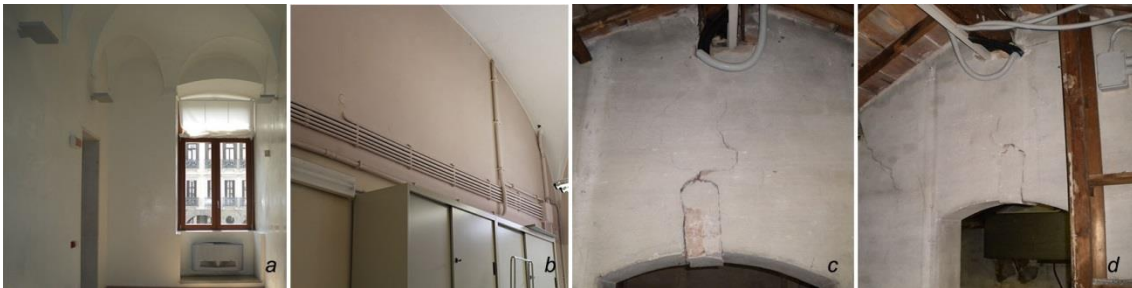
Figura 8.7: a) gli impianti degli ambienti nobili nel palazzo cinquecentesco sono tutti realizzati in traccia; b) canalizzazioni a vista nell' Ala Moschini ; c-d) danni in copertura provocati dalla realizzazione di fori al di sotto di travi portanti.
