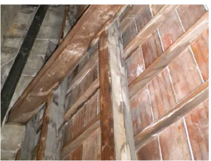
2D Infiltrazioni d'acqua che possono promuovere un ulteriore degrado del legno
