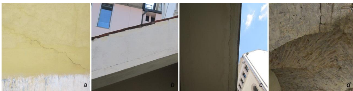
Figura 7.37: a) lesione su un'edicola in corrispondenza della scalinata; b-c) distacco di copriferro di una trave delle edicole; d) lesione in chiave su un arco della sala espositiva.
