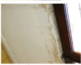
2D1 Degrado dell'intonaco promosso dall'umidità
