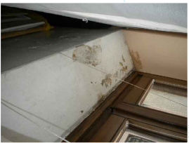
7D Estofazione della pittura muraria e degrado dell'affresco promosso dall'umidità in corrispondenza della finestra
