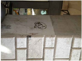
3D) Graffiti vandalici
