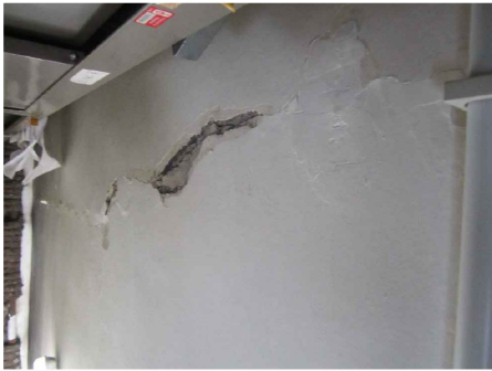
7I Lesione sul soffitto con distacco di intonaco
