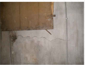
2F Lesione verticale che si propaga a partire da un foro per il passaggio impiantistico
