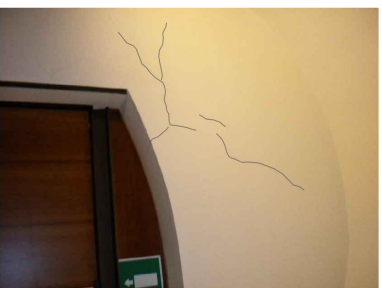
8F | Lesione diagonale sopra un'apertura
