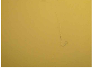
3D) Fessurazione del controsoffitto
