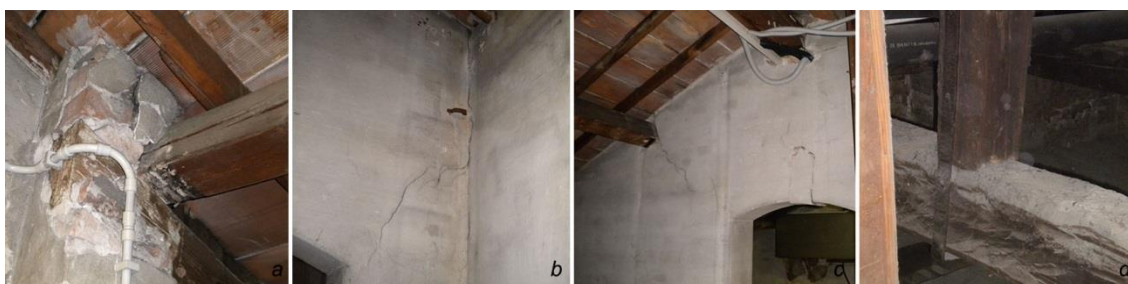
Figura 7.44: a) martellamento di un puntone di copertura su un pilastro; b-c) lesioni in copertura in corrispondenza di aperture nella muratura; d) il monaco delle capriate nella Sala del Consiglio poggia sulla catena.
