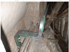
1F Lesione sul ferroso causata da un passaggio impiantistico
