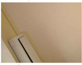
3D1 Fessurazione nel controsoffitto
