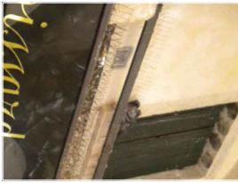
6D) Deposito superficiale su imposta delle volte, maschia su pietra della cornice della finestra
