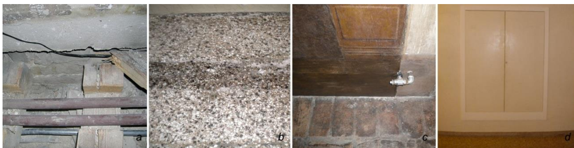
Figura 8.2: a) tubazioni al di sotto del pavimento, Sala della Giunta; b) canalizzazioni nel pavimento della Sala del Consiglio; c) tubazioni in traccia nella Sala dei Nodari; d) nicchia nella Sala Paladin.
