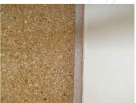
3D Ripartimento dell'intonaco e distacco del battiscopa in corrispondenza di una lesione del pavimento
