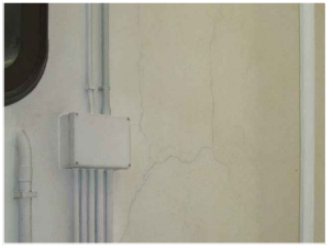
2F) Lesione diagonale passante
