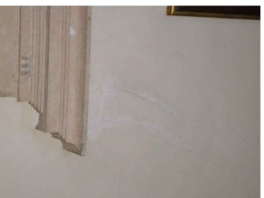
110D Alterazione cromatica e principio di distacco dell'intonaco con fessurazioni risarcite
