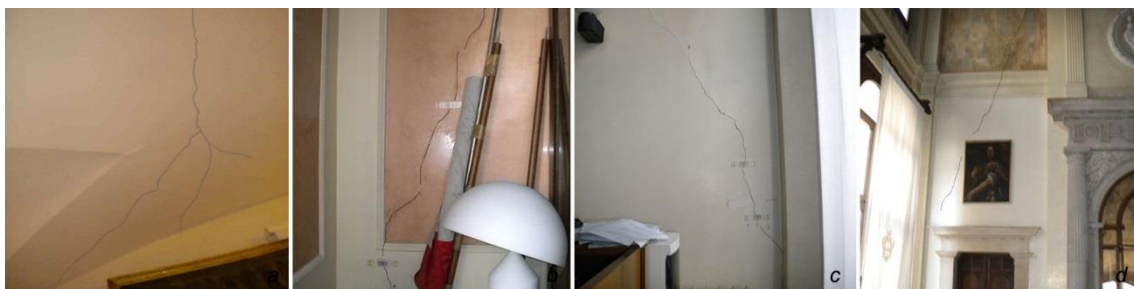
Figura 7.39: a) lesioni longitudinali sulla volta della Sala Paladin al piano primo; b-c) lesione passante sulla parete che separa Sala della Giunta e Sala del Consiglio; d) lesione sulla parete frontale alla precedente nella Sala del Consiglio.
