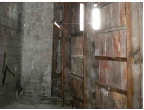
7D Infiltrazione d'acqua in copertura e lungo la parete, sulla quale compare anche una macchia da attacco biologico
