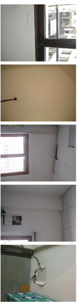
1D Rigolamento dell'intonaco promosso dall'umidità 2D Fessurazioni diffuse sul controsoffitto 3D Rigolamento dell'intonaco promosso dall'umidità 4D Rigolamento dell'intonaco promosso dall'umidità 5D Lesione nella parete in cantogesso
