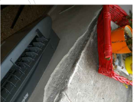
2D Distacco dell'intonaco
