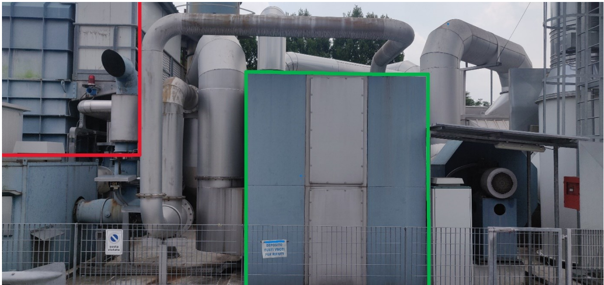
Figura 2.8: foto dell'impianto d'abbattimento delle sostanze organiche volatili con in primo piano la struttura contenente una dei due rotori di zeoliti e sulla destra le camere di post-combustione
