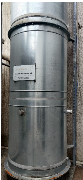
Figura 2.6: punto di prelievo in testa all'impianto d'abbattimento
