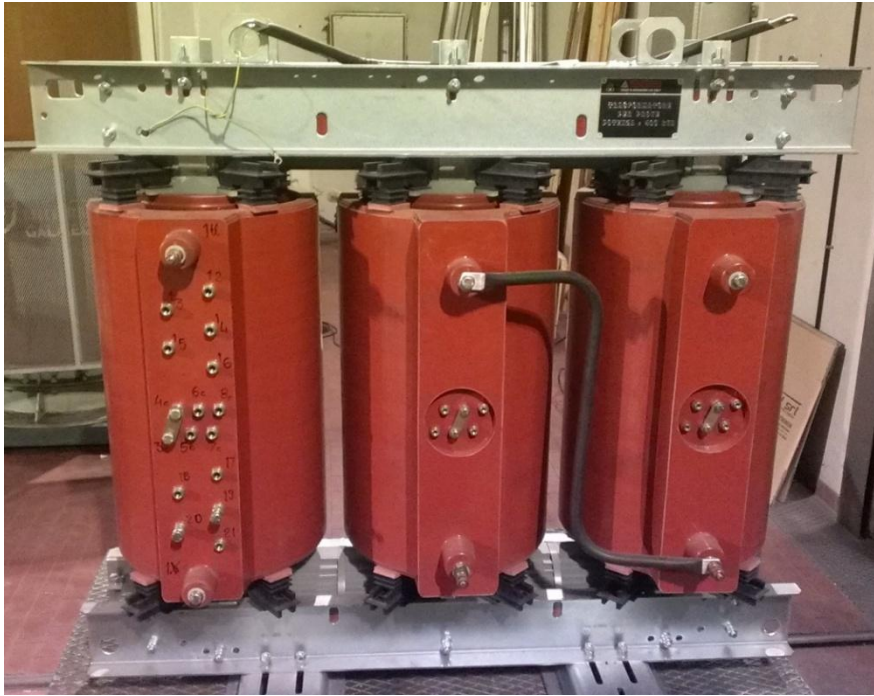
Figura 7.6 Trasformatore per prove in resina da 400 kVA
