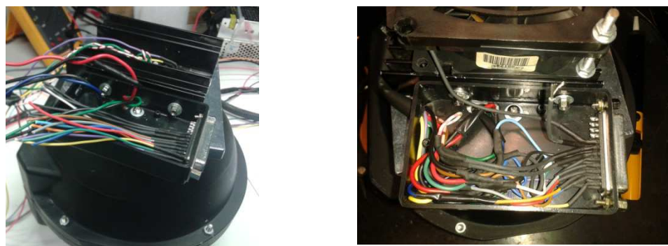
Fig.3.6 (a) Conduttori precedenti – (b) Nuovi collegamenti
