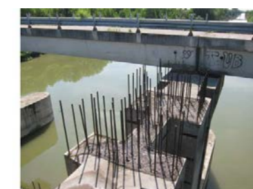
Particolare dei ferri scoperti delle pile
