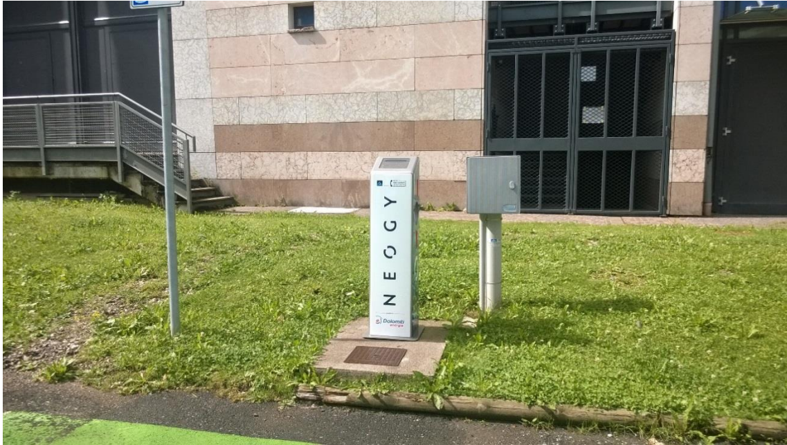
Figura 28 Stazione di ricarica elettrica installata da Neogy situata a Moena (TN)
