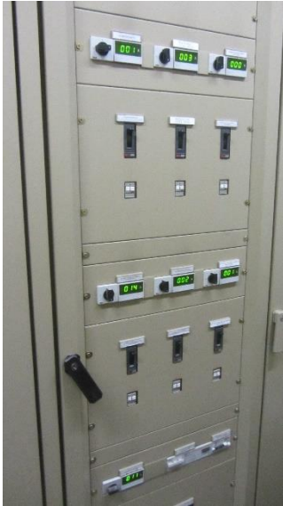
Figura 12 Quadro generale di distribuzione in locale tecnico
