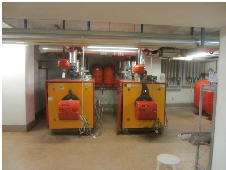
Figura 14 Centrale termica area antica: generatori di calore a gasolio
