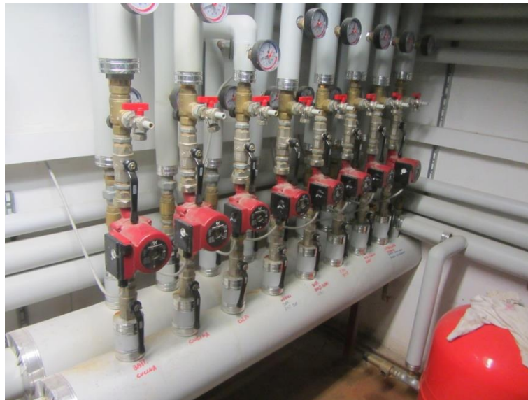
Figura 15 Pompe di ricircolo – dettaglio collettore secondario
