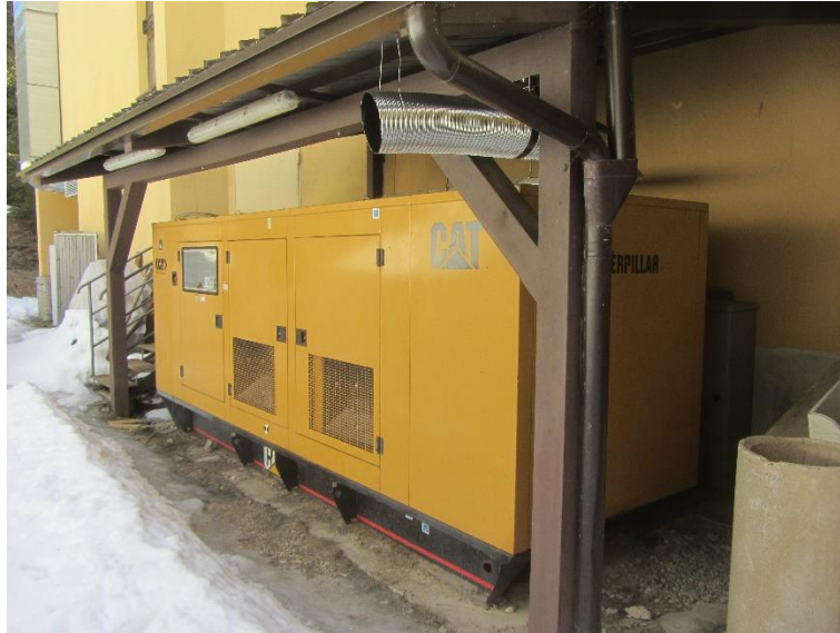
Figura 13 Gruppo elettrogeno a diesel
