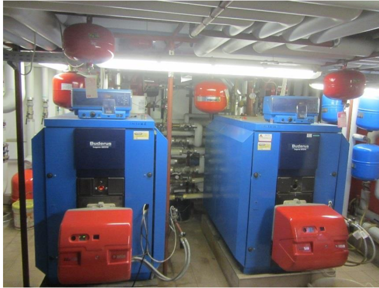
Figura 16 Centrale termica area nuova: generatori di calore a gasolio
