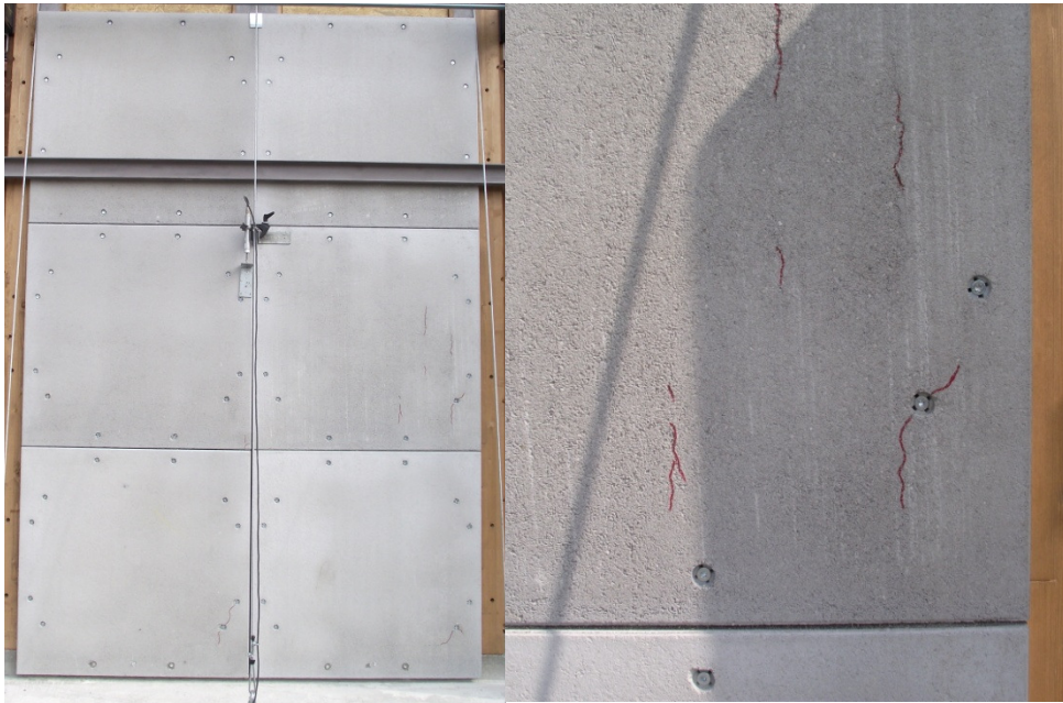
Figura 4.20 – Vista delle connessioni delle lastre in c.a. (sinistra) fessure nelle lastre in c.a. (destra)
