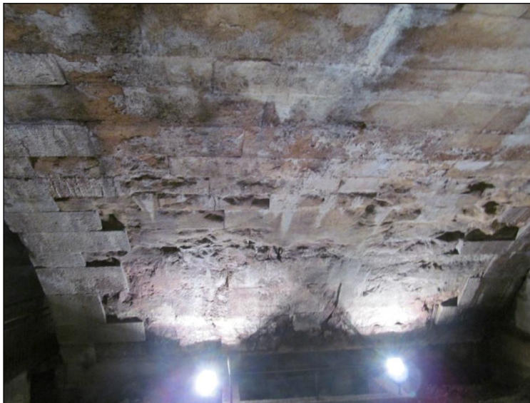
Figura 63: Alterazione cromatica sulla seconda arcata.
