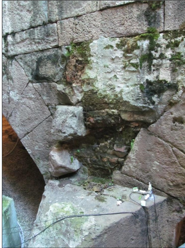
Figura 72: Patina biologica presente sulla prima pila del ponte.
