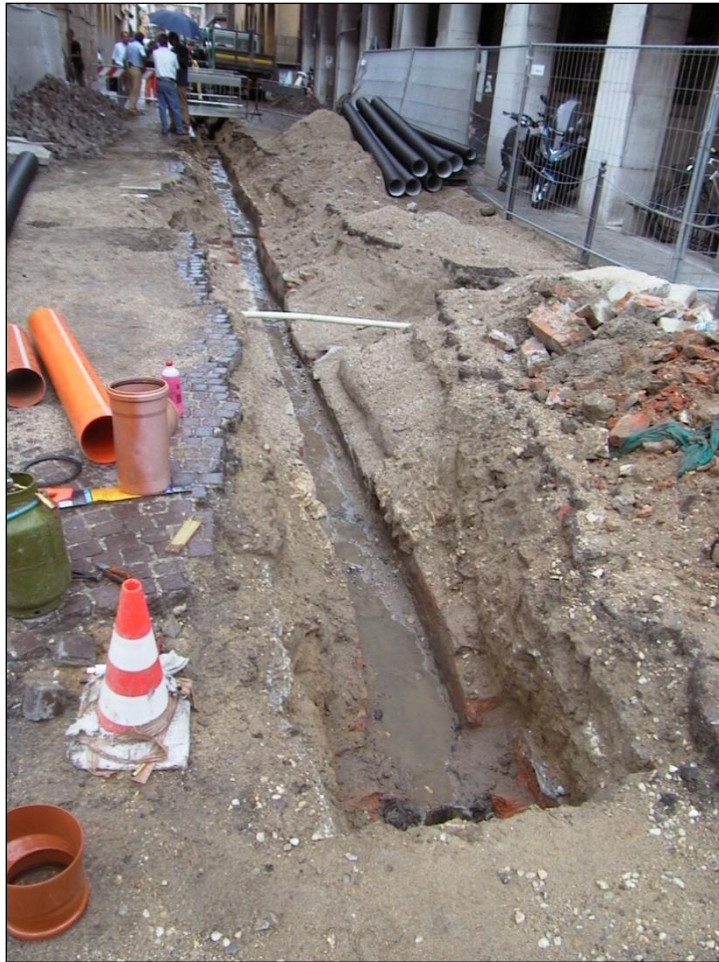
Figura 140: Canale di scolo al centro di via S. Francesco. (Comune di Padova).
