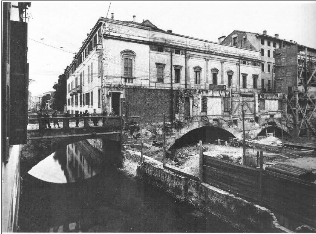
Figura 50: Il ponte di S. Lorenzo nel 1938 durante i lavori di ristrutturazione del Palazzo del Bo (Tosi, 1987).
