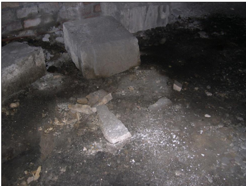
Figura 66: Distacco di materiale lapideo sulla terza arcata.
