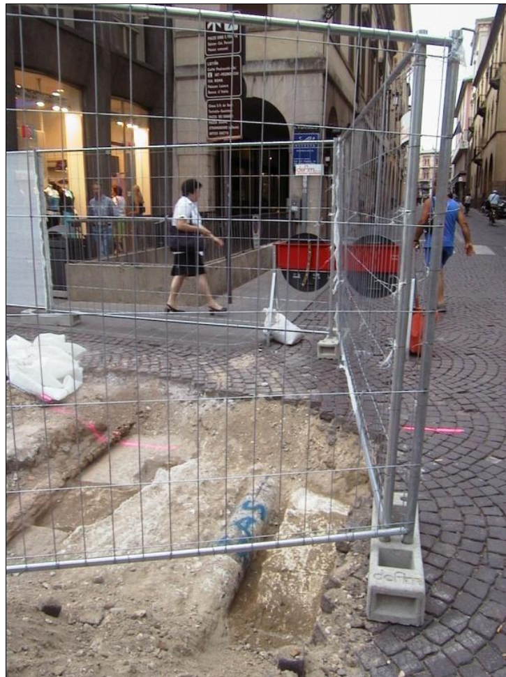
Figura 103: Le tubature del gas (Comune di Padova).
