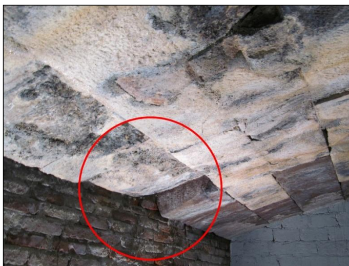
Figura 70: Mancanza di una parte di un concio sulla prima arcata in prossimità delle mura medievali.
