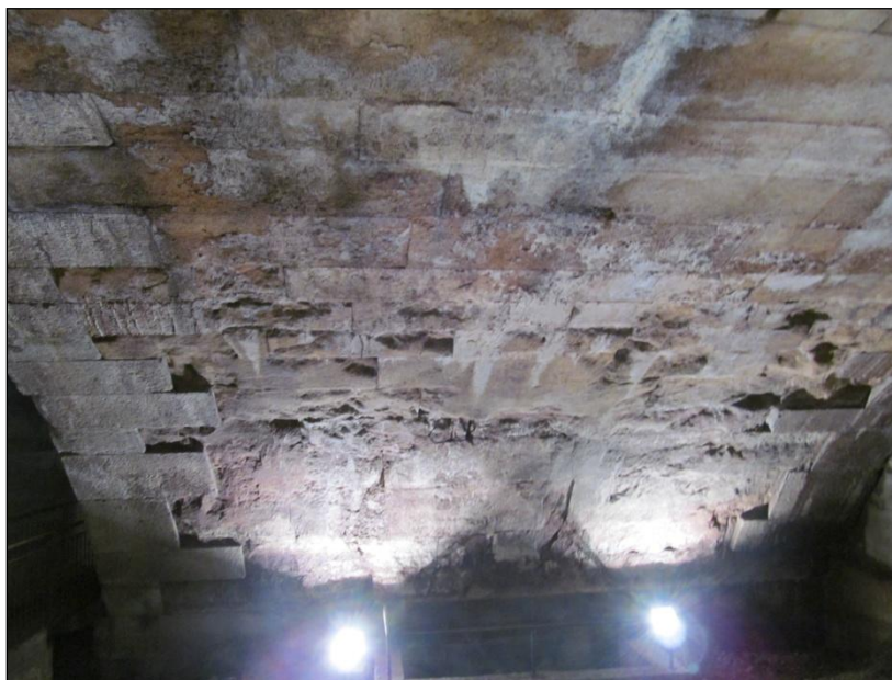
Figura 67: Efflorescenza di gran parte della seconda arcata.
