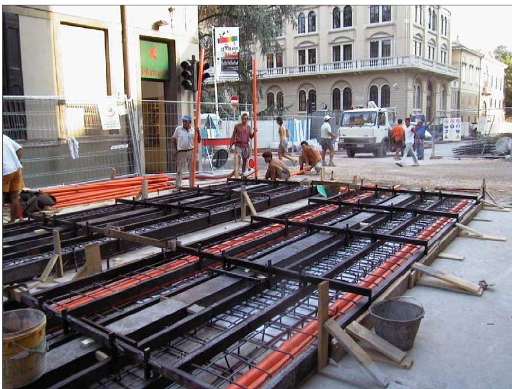
Figura 98: I lavori di posa del cemento armato precedenti alla posa delle rotaie del tram (Comune di Padova).
