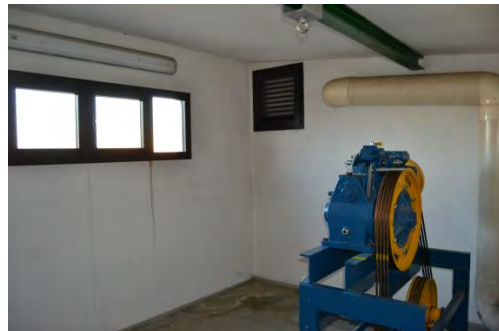
Figura 4.23 Locale tecnico ascensore al terzo piano
