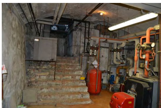
Figura 2.5 Centrale termica, Piano Interrato
