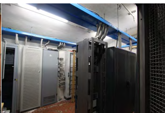
Figura 2.6 Sala server, Piano Interrato
