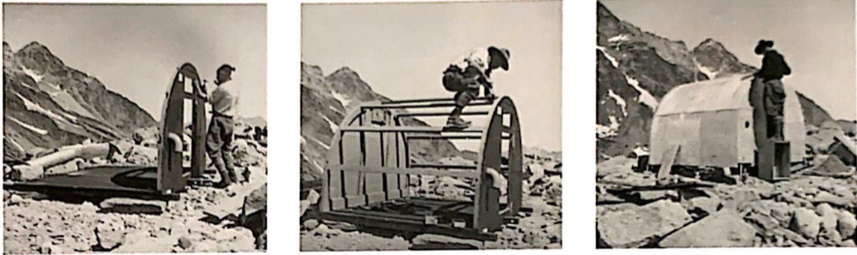
Figura 6: Fasi di montaggio di un bivacco Revelli [Fonte: Luca Gibello, Cantieri d'alta quota Breve storia della costruzione dei rifugi sulle Alpi, 201, pag. 7
