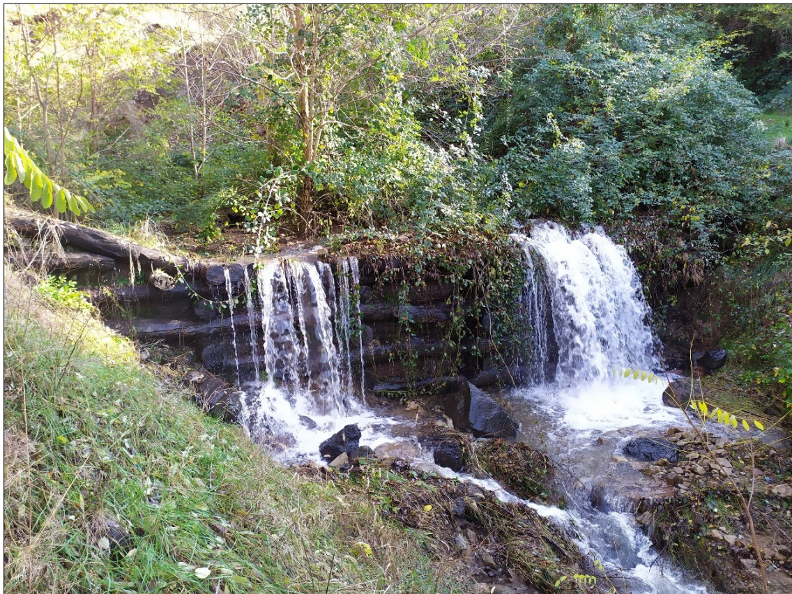
Figura 2.15: briglia in legname e pietrame lungo il corso del torrente al piede della frana come si presenta oggi.
