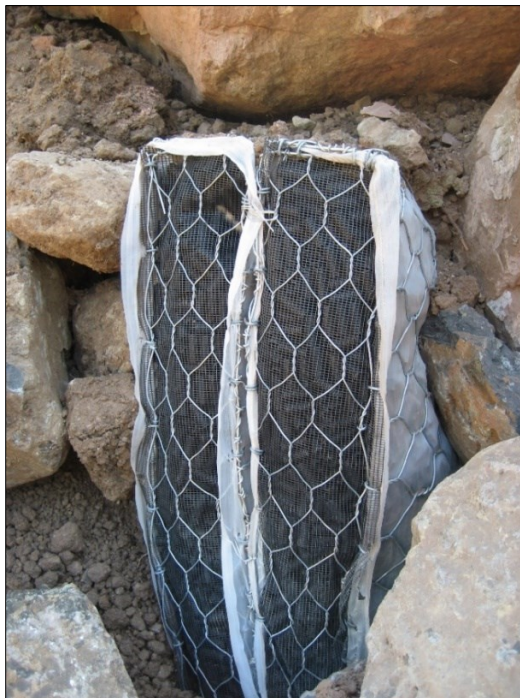
Figura 2.12: trincea drenante gabbiodren® usata nell’intervento di sistemazione (Archivi dei Servizi Forestali Regionali del Veneto).
