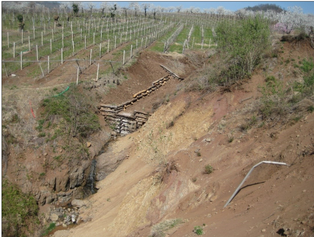
Figura 2.16: supporto spondale realizzato nel 2012 in seguito a erosione spondale nella zona della cascata (Archivi dei Servizi Forestali Regionali del Veneto).
