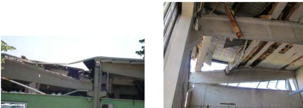
Figura 1.3: Esempi di perdita di appoggio
