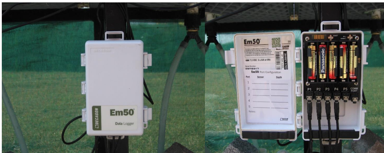
Fig. 5.21 Data Logger Em50 fissato alla struttura (sinistra) e dettaglio del suo interno (destra)
