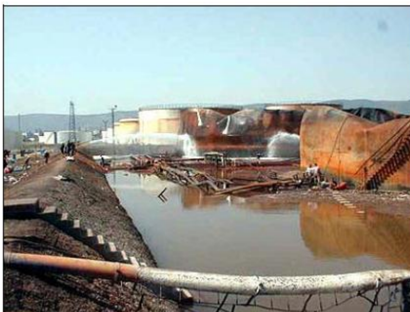
Fig. 3.4- Raffineria di Tupra (Turchia) dopo il terremoto di Kocaeli 1999
