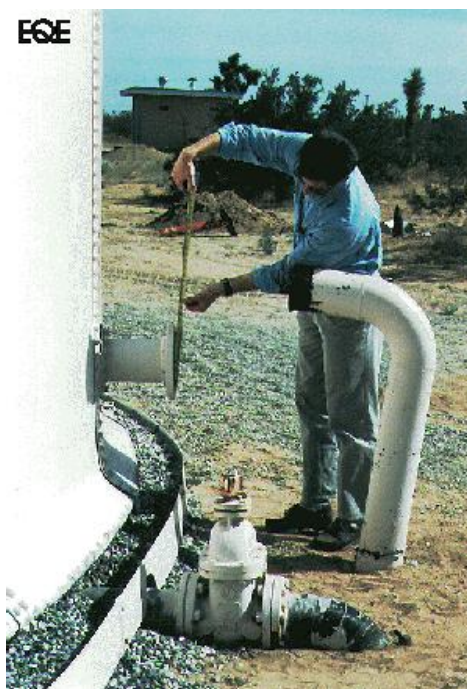
Fig.3.1-Distacco delle tuazioni da un serbatoio a causa dell'azione sismica
