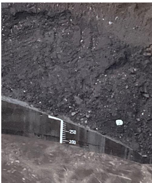
Imagen n.12: Sistema de monitoreo actual de la subida del nivel del agua en el embalse de la quebrada de El Tejado, compuesto por una cámara y el dibujo de una regla.
