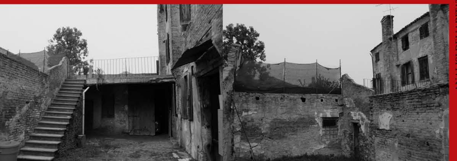
9 DESTINAZIONE D'USO: Edificio collabente
